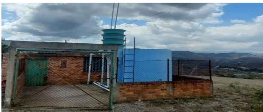
Figura 4. Torre de aireación PTAP Roa y Carrizal
