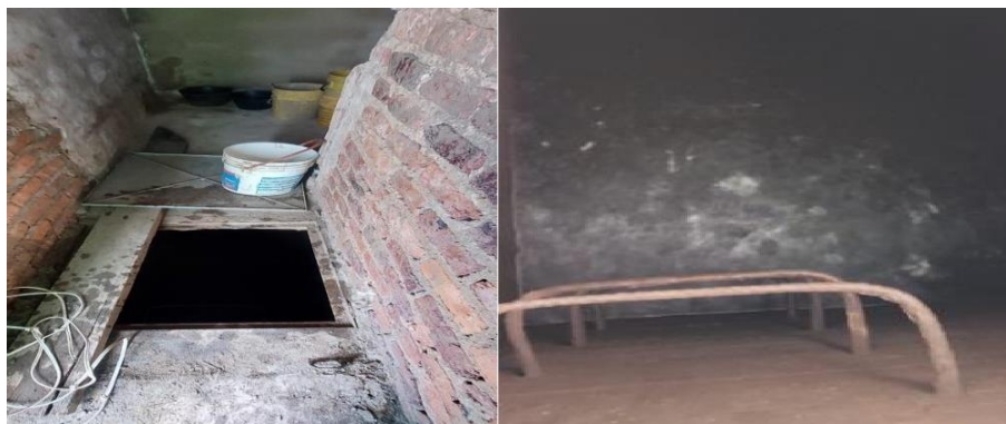
Figura 7. Tanque de almacenamiento PTAP Roa y Carrizal
