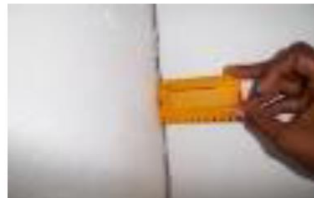
GRIETAS AL INTERIOR
