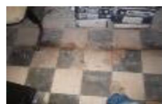
PISOS CON HUNDIMIENTO
