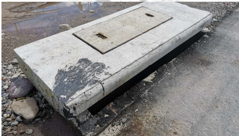
Imagen 14. Sumidero con deficiente área de captación, Eje 5 K0+185.
