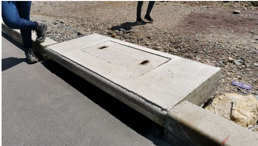
Imagen 4. Sumidero con área de captación reducida, Eje 10 K0+071.
