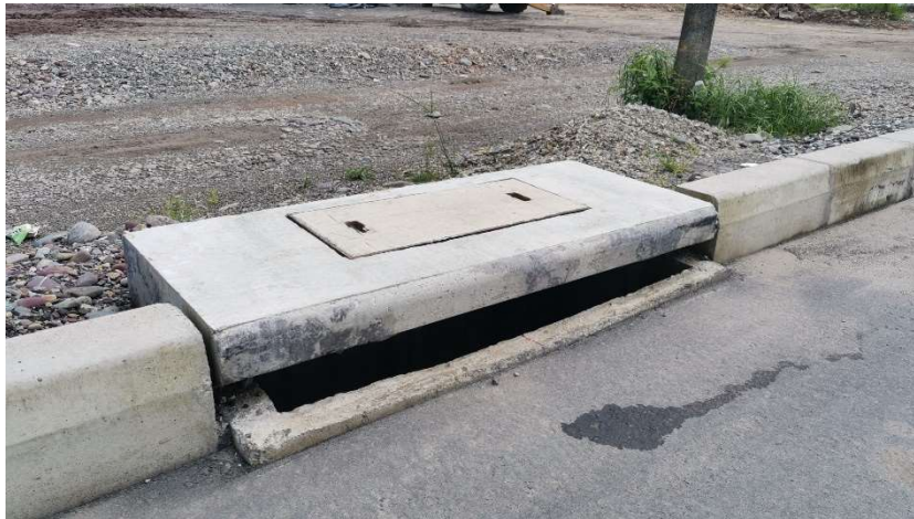
Imagen 16. Sumidero con deficiente área de captación, Eje 5 K0+115.
