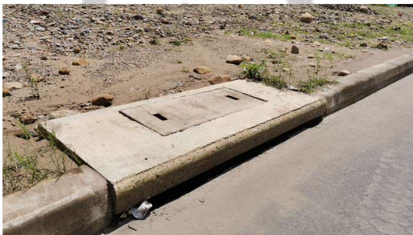
Imagen 18. Sumidero con área de captación reducida, Eje 3 K0+090
