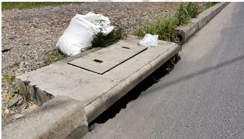
Imagen 5. Tapa de Sumidero mal alineado, Eje 10 K0+105.
