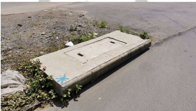
Imagen 9. Sumidero con área de captación reducida, K2+243 calzada izquierda en separador.
