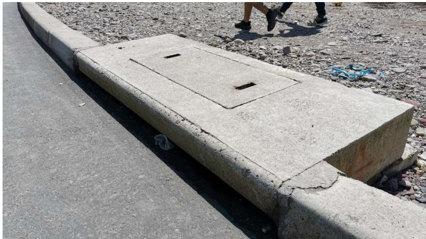
Imagen 1. Sumidero con área de captación reducida, Eje 10 K0+160.
