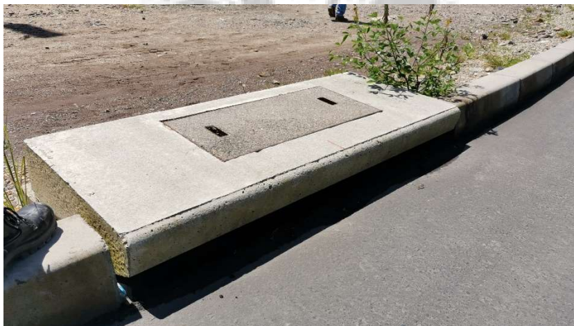
Imagen 2. Sumidero con área de captación reducida, Eje 10 K0+140.
