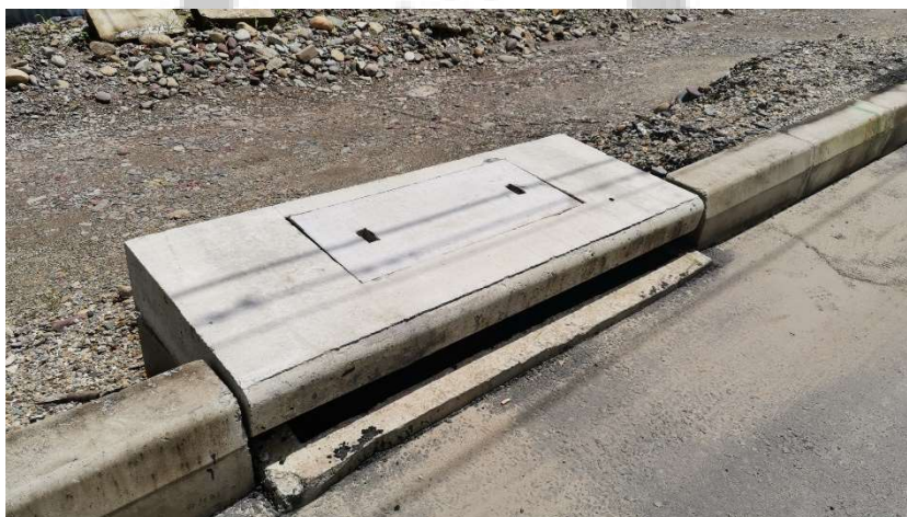
Imagen 15. Sumidero con deficiente área de captación, Eje 5 K0+163.
