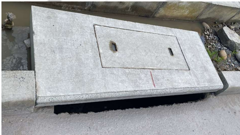
Imagen 12. Sumidero con área de captación reducida, K2+280 calzada derecha.
