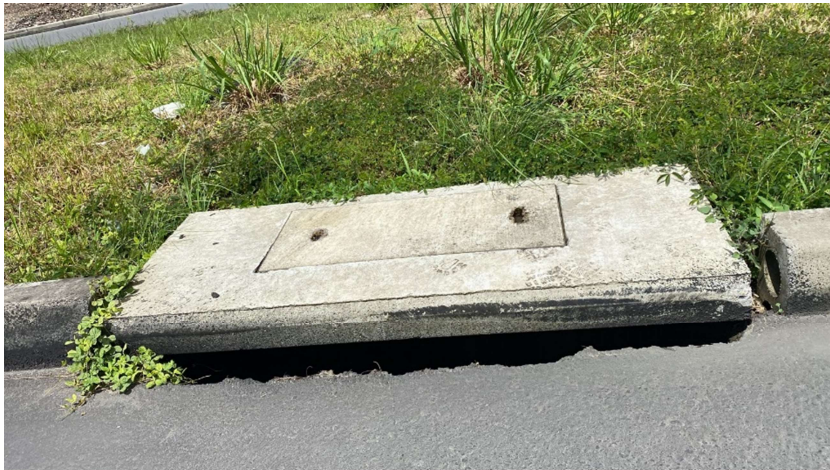
Imagen 7. Tapa de Sumidero mal alineado, Eje 9 K0+025
