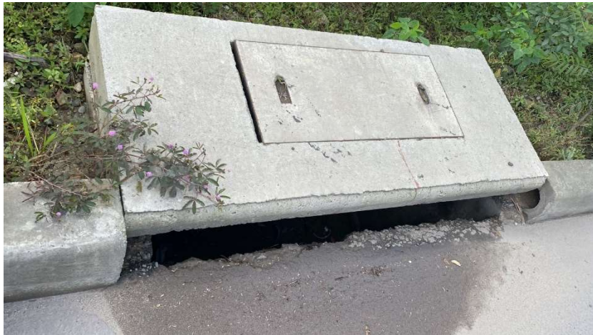
Imagen 10. Tapa de Sumidero mal alineada, K2+420 calzada derecha.
