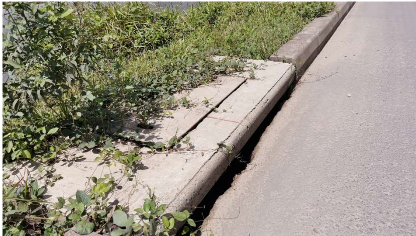
Imagen 13. Sumidero con área de captación reducida, K2+315 calzada izquierda en separador.
