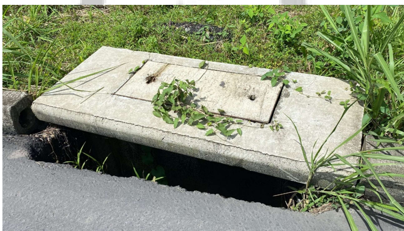
Imagen 6. Tapa de Sumidero mal alineado, Eje 9 K0+045.
