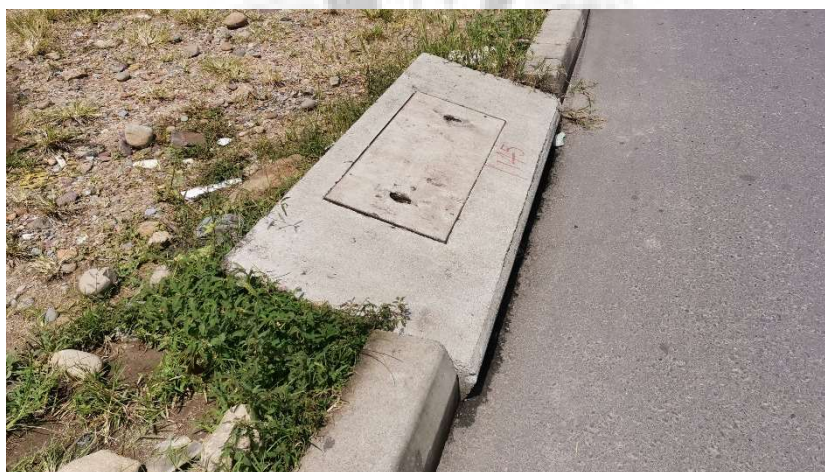
Imagen 20. Tapa de Sumidero mal alineada, Eje 11 K1+145.
