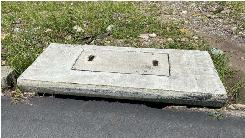
Imagen 8. Sumidero con área de captación reducida, Eje 9 K0+015.
