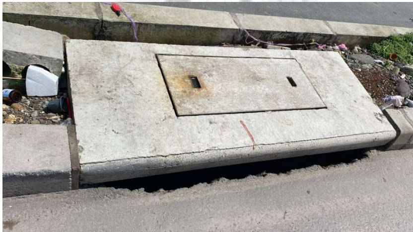
Imagen 11. Sumidero con área de captación reducida, K2+370 calzada derecha.
