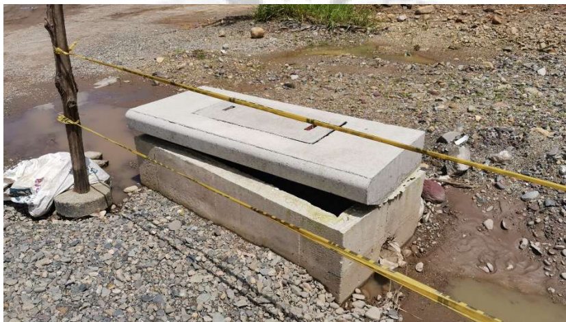
Imagen 17. Sumidero con deficiente área de captación, Eje 5 K0+084.
