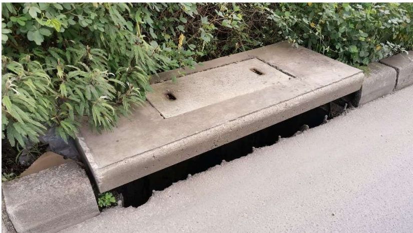
Imagen 19. Exposición de aceros en sumidero, K2+434 calzada izquierda en separador.
