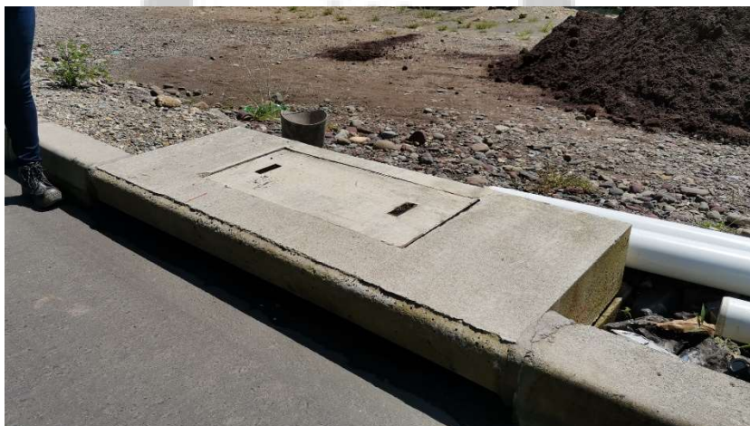
Imagen 3. Sumidero con área de captación reducida, Eje 10 K0+115.
