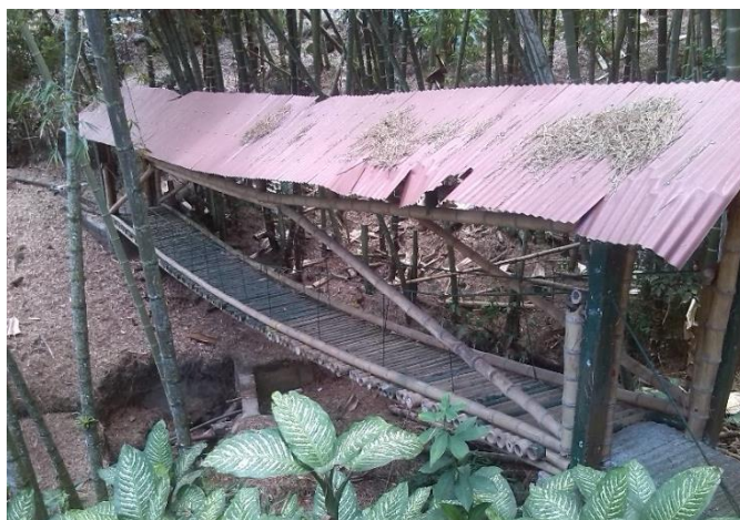
Figura 2. Puente en guadua deteriorado de la finca El Centenario
