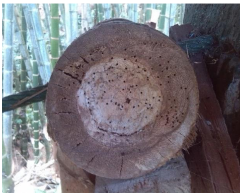
Figura 1. Elementos en guadua del puente peatonal afectados por insectos xilófagos
