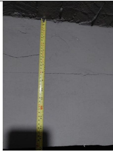
Fotografía 4. Medición de distancia entre fisuras de placa de entrepiso.
