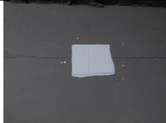
Fotografía 6. Control de fisuras en fisura 09 marzo 2024
