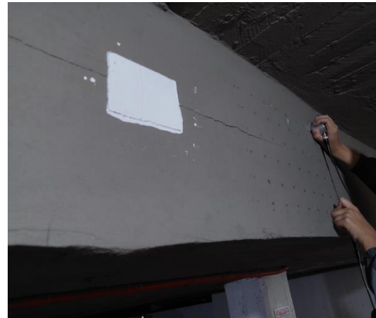
Fotografía 8. Control de fisuras en fisura 01 junio 2024
