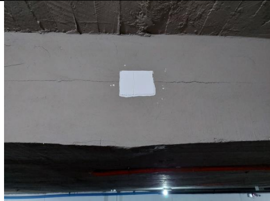
Fotografía 5. Control de fisuras en fisura 08 febrero 2024
