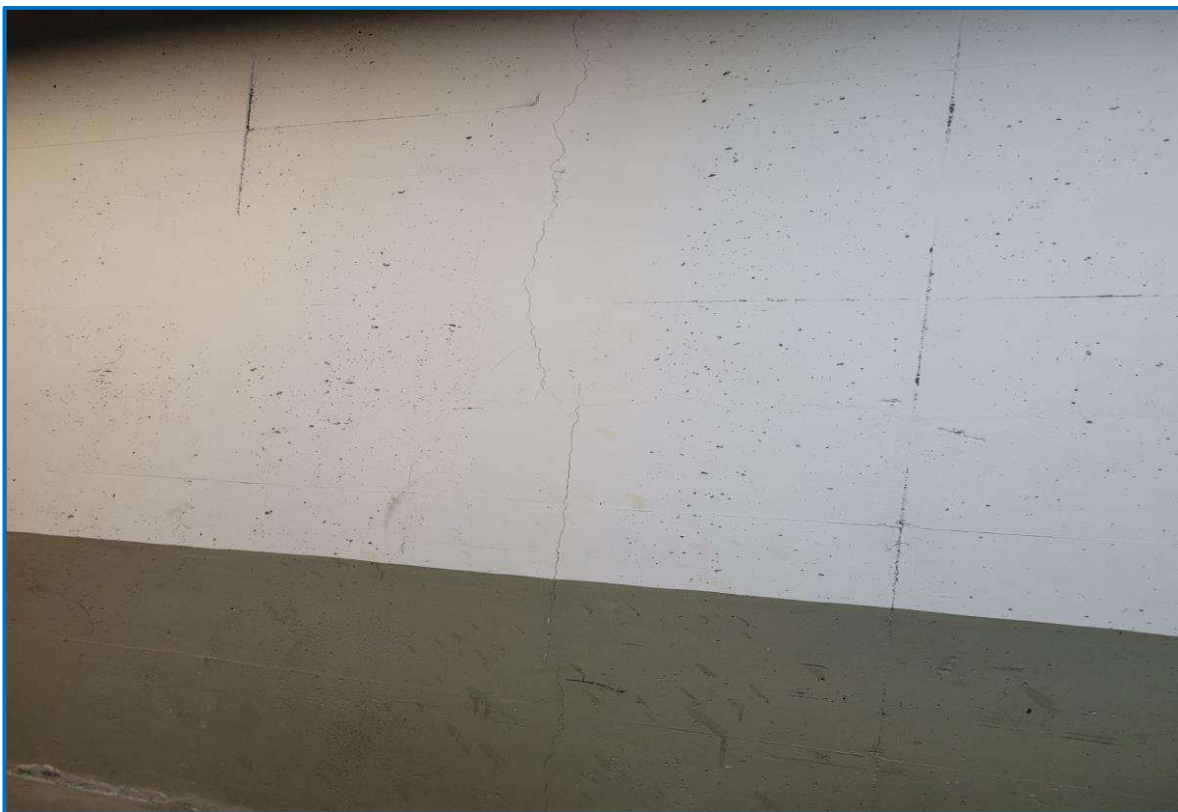
Fotografía 9: Lesión mecánica, se presenta fisura en muro estructural de contención ubicado en el sótano dos junto a la rampa de acceso vehicular.
