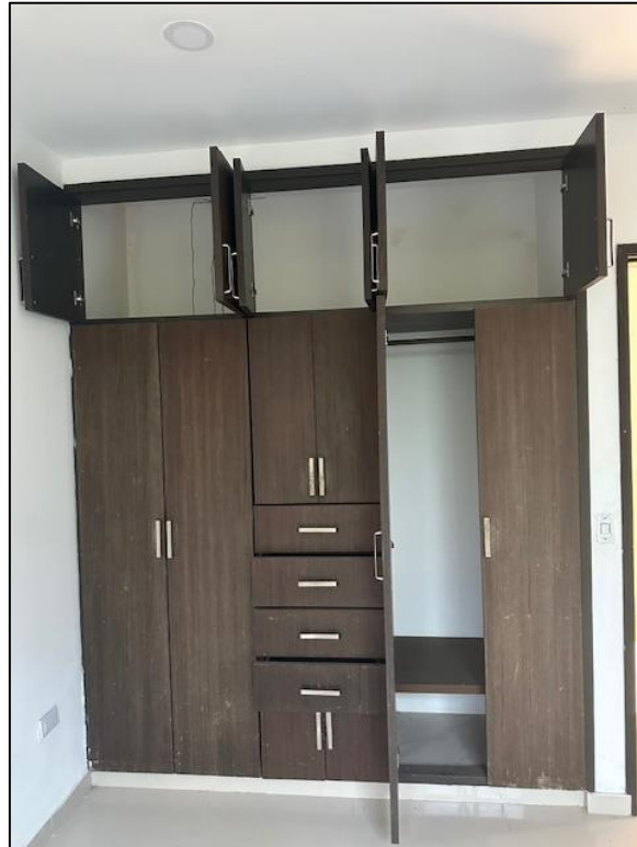
Figura 28. Fotografía detalle del estado actual madera de closets. (Fuente propia)
