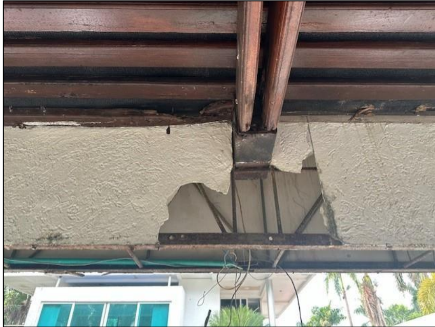
Figura 15. Fotografía estado actual de la estructura en madera y perfiles en acero del salón exterior. (Fuente propia)
