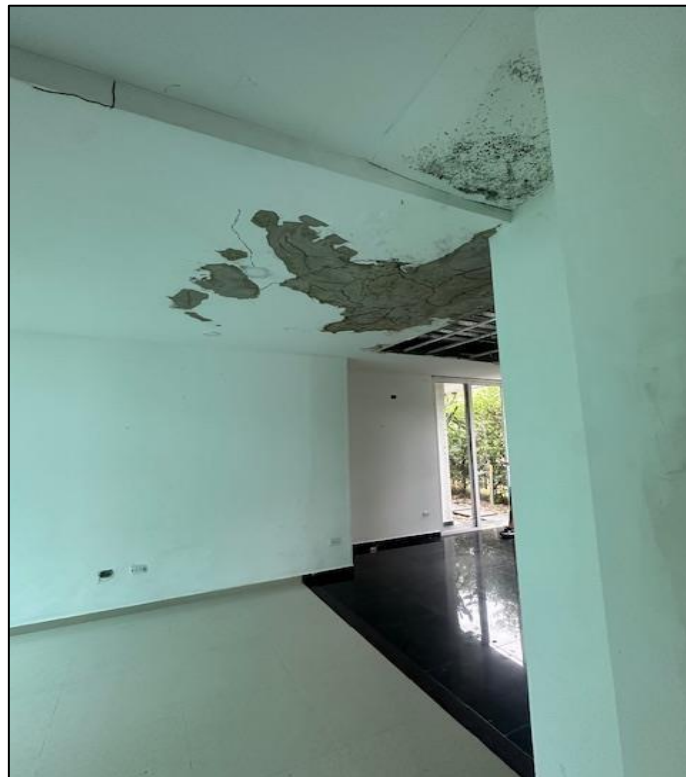
Figura 24. Fotografía detalle del estado actual muros internos y cielorraso primer piso. (Fuente propia)
