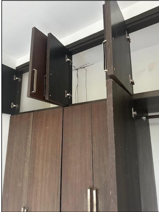
Figura 27. Fotografía detalle del estado actual madera de closets. (Fuente propia)
