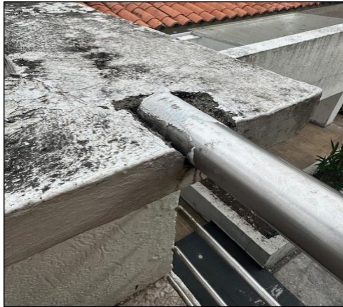
Figura 29. Fotografía detalle del estado de la alfajía en concreto reforzado terraza segundo piso. (Fuente propia)
