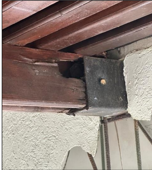
Figura 17. Fotografía detalle del estado actual de la estructura en madera y perfiles en acero del salón exterior. (Fuente propia)
