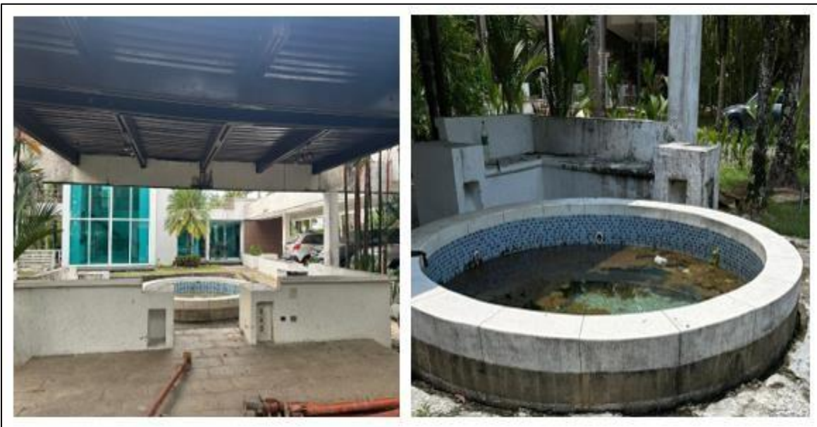
Figura 34. Vista general del estado de Deterioro del Jacuzzi (Fuente Propia)
