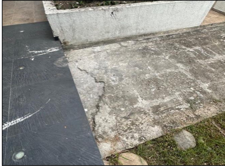
Figura 12. Fotografía estado actual de la anden exterior. (Fuente propia)
