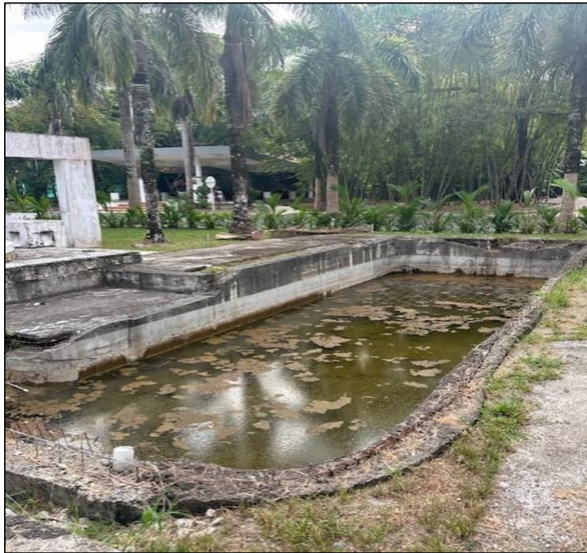
Figura 10. Fotografía estado actual de la estructura de la piscina. (Fuente propia)
