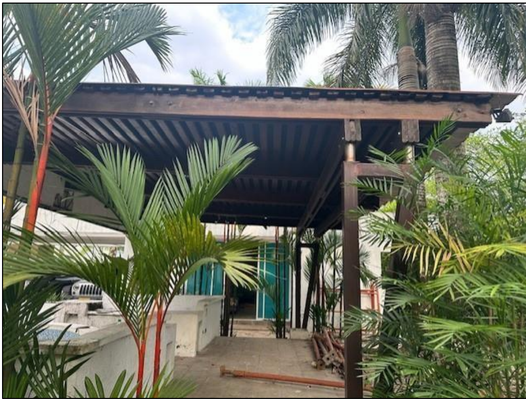
Figura 14. Fotografía estado actual de la estructura en madera del salón exterior. (Fuente propia)
