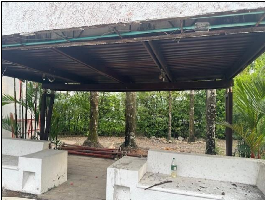
Figura 18. Fotografía detalle del estado actual pandeado de la estructura en madera del salón exterior. (Fuente propia)
