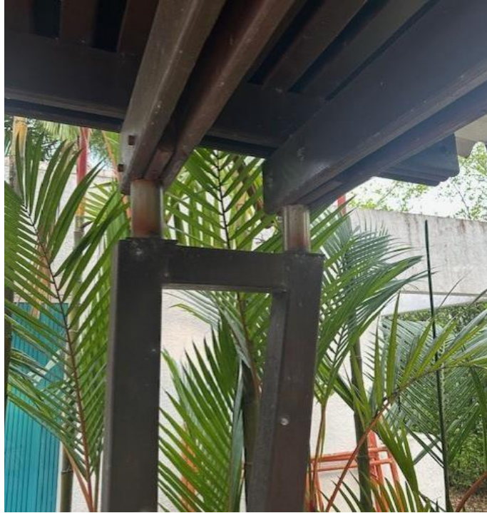
Figura 19. Fotografía detalle del estado actual pandeado de la estructura en madera del salón exterior y corrosión en elementos metálicos estructurales. (Fuente propia)
