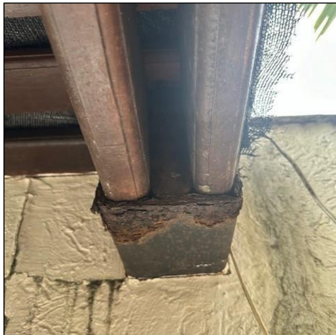
Figura 16. Fotografía detalle del estado actual de la estructura en madera y perfiles en acero del salón exterior. (Fuente propia)
