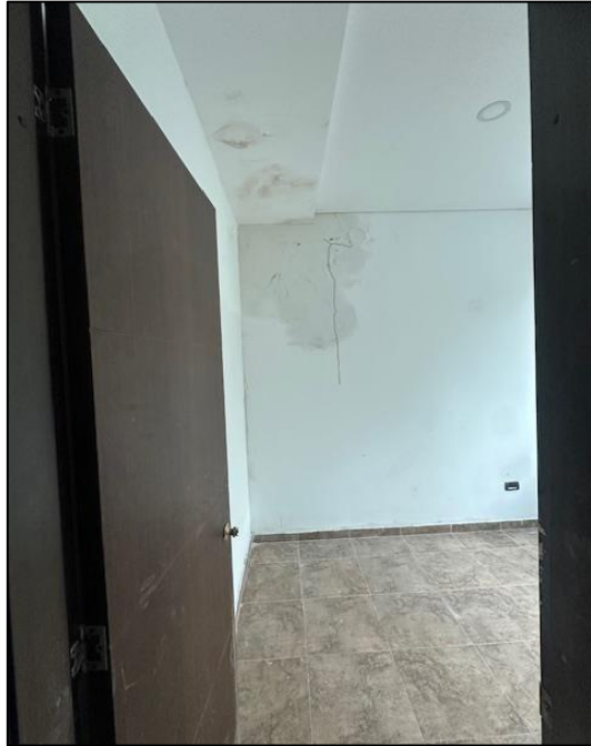
Figura 23. Fotografía detalle del estado actual muros internos. (Fuente propia)
