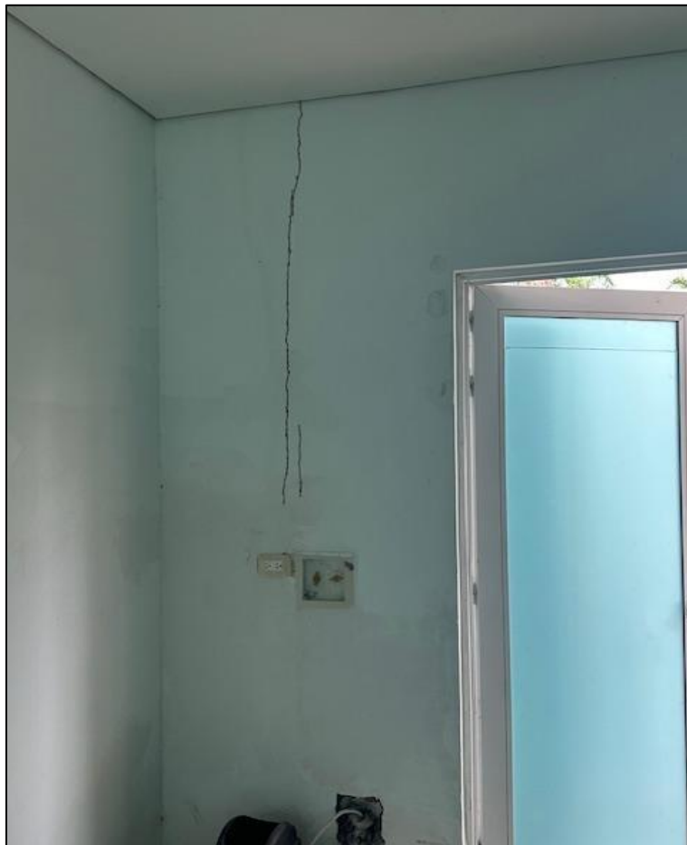
Figura 22. Fotografía detalle del estado actual muros internos. (Fuente propia)
