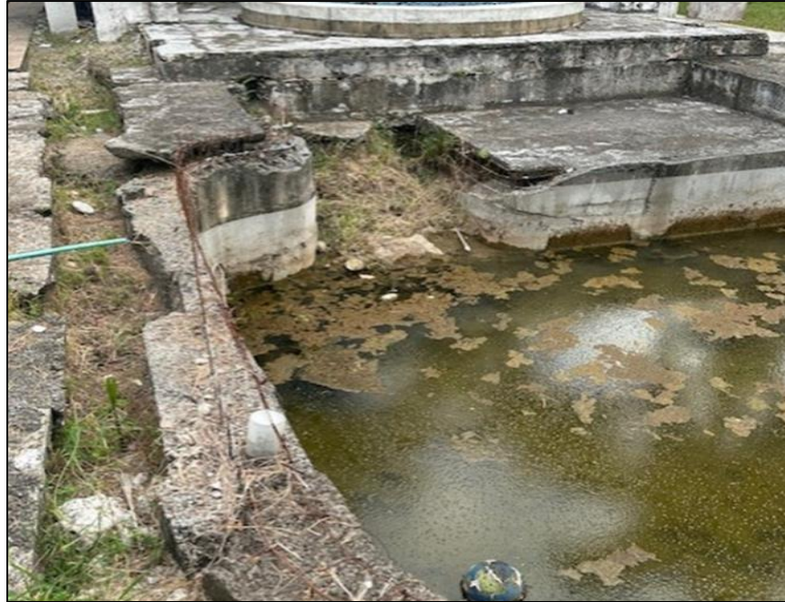
Figura 11. Fotografía estado actual de la estructura de la piscina. (Fuente propia)
