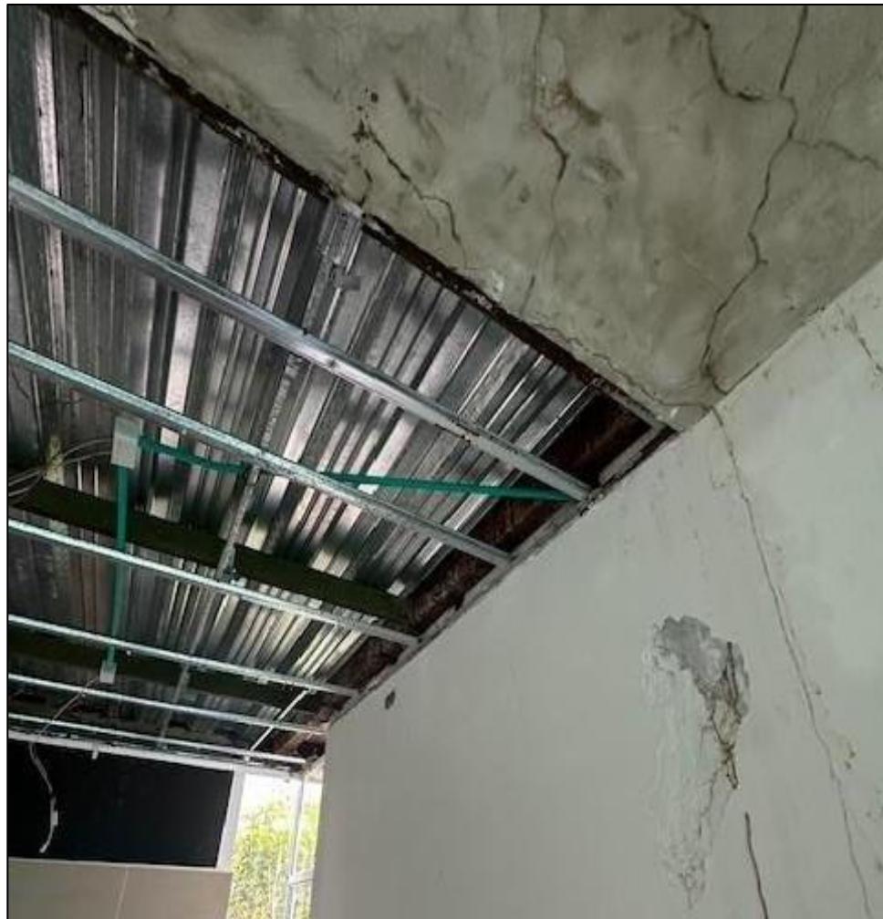
Figura 25. Fotografía detalle del estado actual muros internos, cielorraso primer piso y estructura de la placa de entrepiso piso 2. (Fuente propia)
