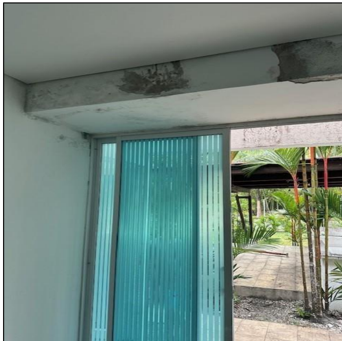
Figura 21. Fotografía detalle del estado actual de muros internos. (Fuente propia)
