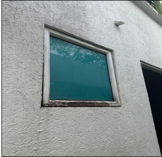
Figura 20. Fotografía detalle del estado actual de ventanas en aluminio. (Fuente propia)
