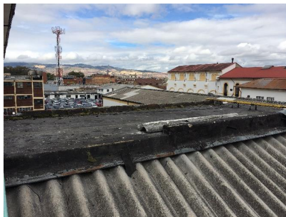
Ilustración N°8-29: Falta de caballete entre unión de la placa y teja de asbesto cemento.
