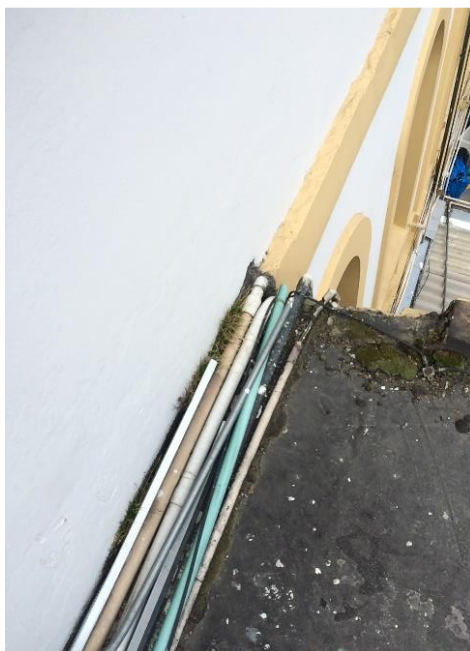
Ilustración N°8-31: Unión de la placa de cubierta y fachada patrimonial pabellón colindante, se encuentran lesiones de tipo biológico. Fuente: Autor
