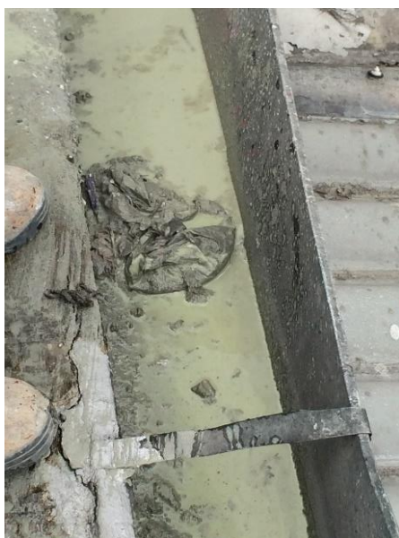
Ilustración N°8-23: Estado de las canales. Fuente: Autor
