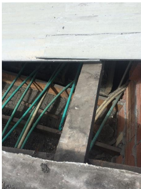
Ilustración N°8-25: Unión estructura de cubierta y muro en mampostería (no se observa viga). Fuente: Autor
