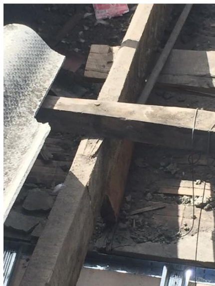
Ilustración N° 8-28: Sección de la cercha en madera cortadas para instalación de ductos, mala disposición de los elementos. Fuente: Autor
