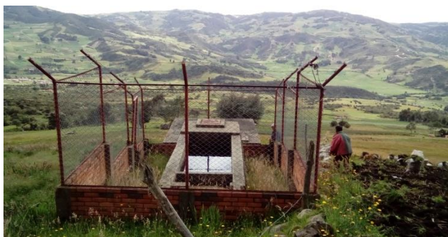
Fotografía 8 Desarenador acueducto Guancha, municipio Chiquiza, Boyaca. Fuente: El Autor (2016).
