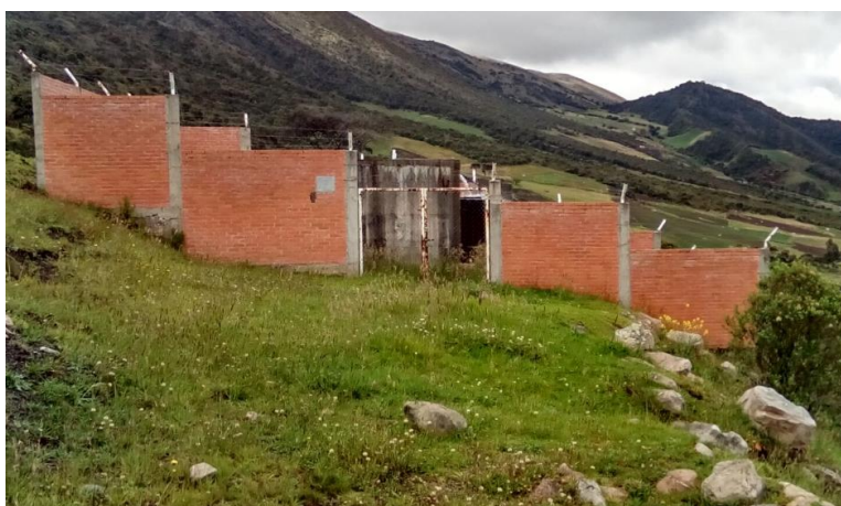
Fotografía 13 Tanque de almacenamiento – Acueducto Cazadero. El Autor (2016).
