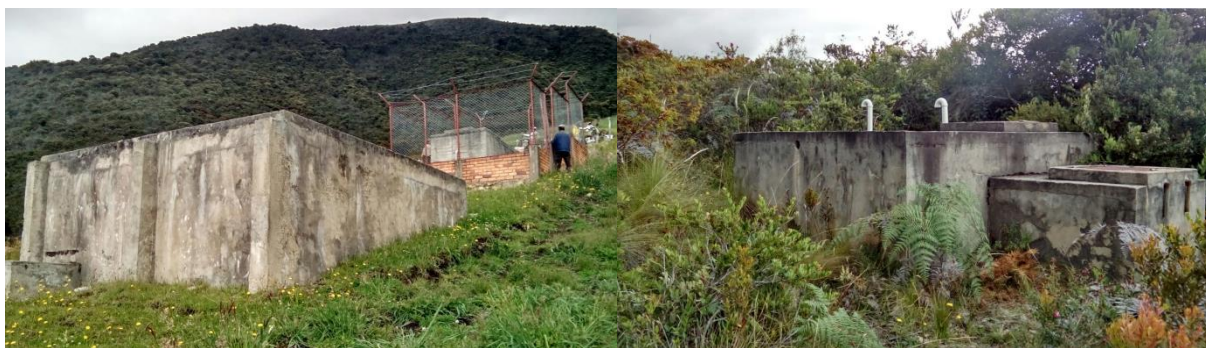
Fotografía 17 Tanques de almacenamiento – Acueducto Guancha. Fuente: El Autor (2016).
