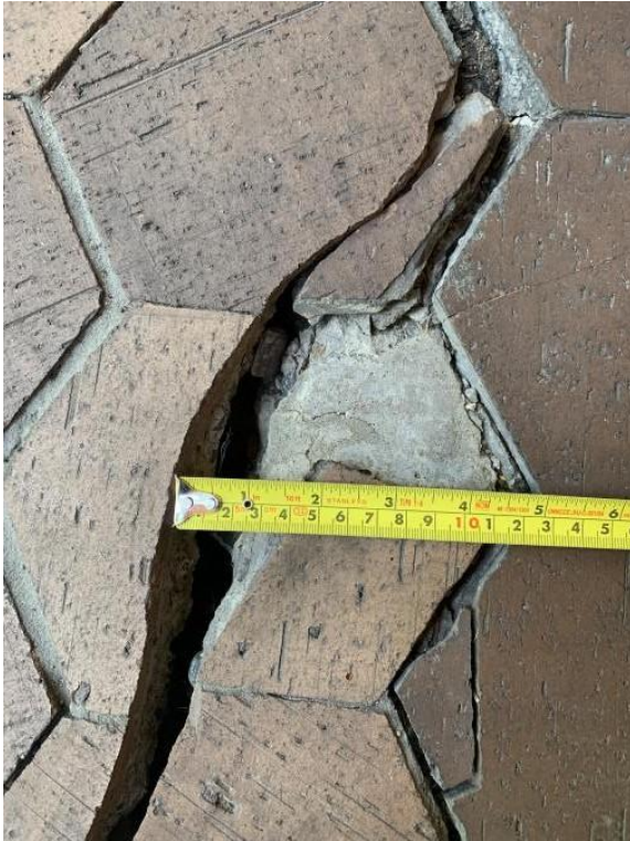
Figura 42. Grieta 4 / Fuente: Propia.
