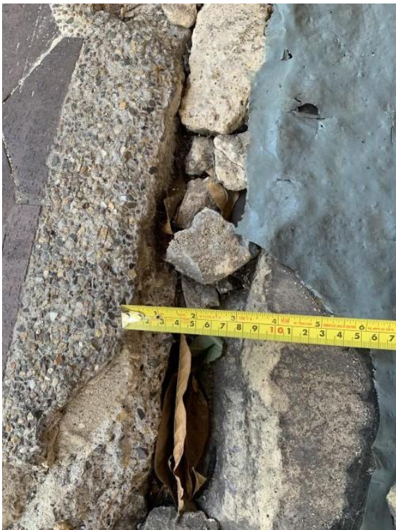
Figura 43. Grieta 5 / Fuente: Propia.
