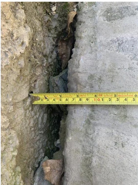
Figura 44. Grieta 6 / Fuente: Propia.
