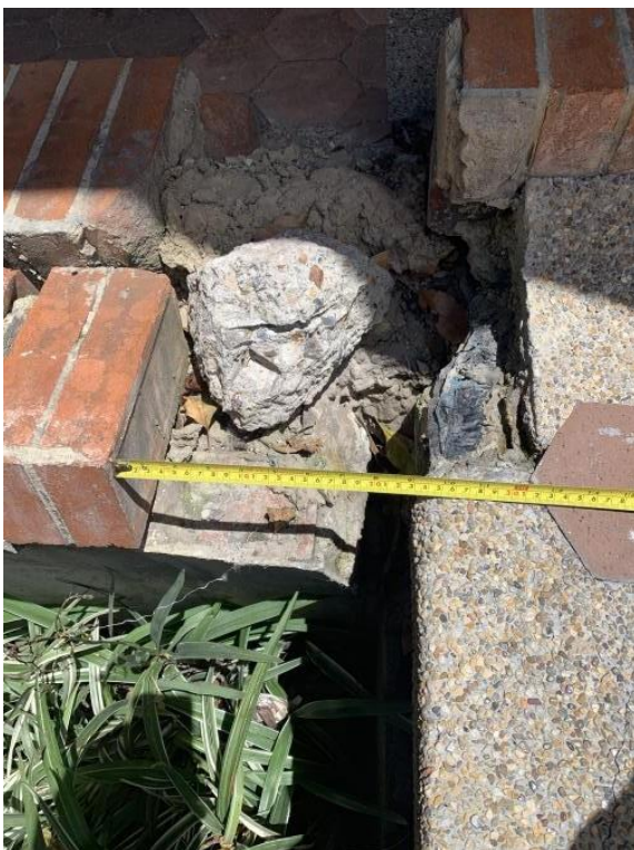
Figura 41. Grieta 3 / Fuente: Propia.
