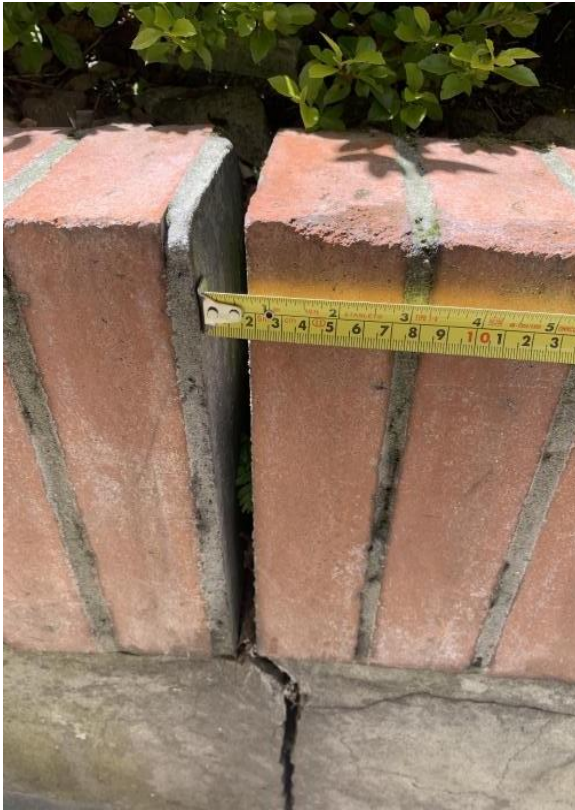
Figura 39. Grieta 1 / Fuente: Propia.
