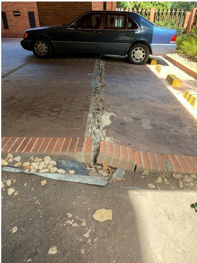
Figura 38. Lesión mecánica / fuente: Propia.
