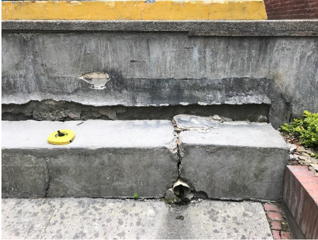
Figura 37. Lesión mecánica / fuente: Propia.
