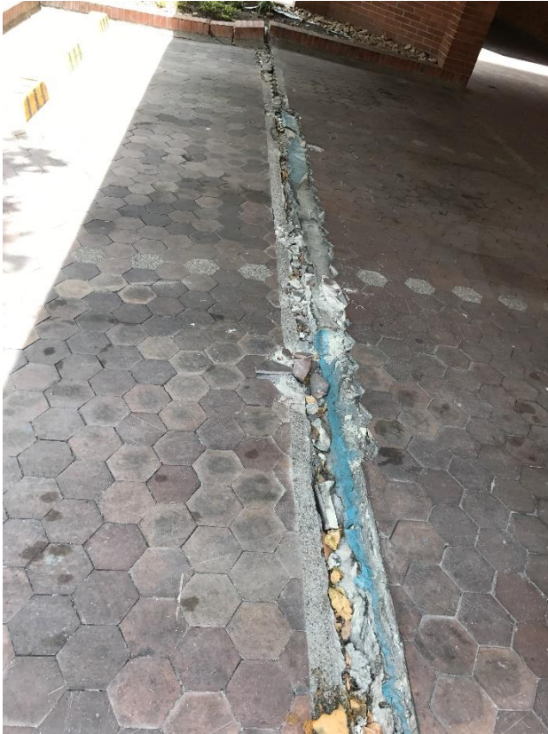
Figura 36. Lesión mecánica / fuente: Propia.
