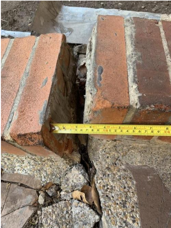
Figura 40. Grieta 2 / Fuente: Propia.
