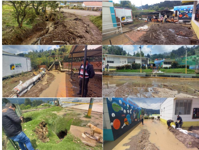
Figura 13. Afectaciones ola invernal IET Salamanca sede Secundaria.
