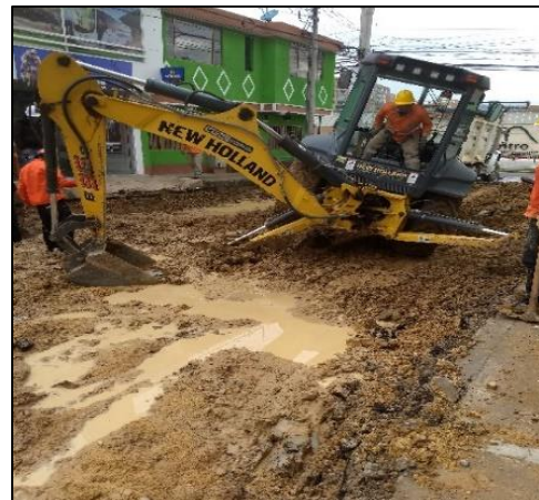
Ilustración 26. Subrasante afectada por Lluvias y Daño de acometidas
