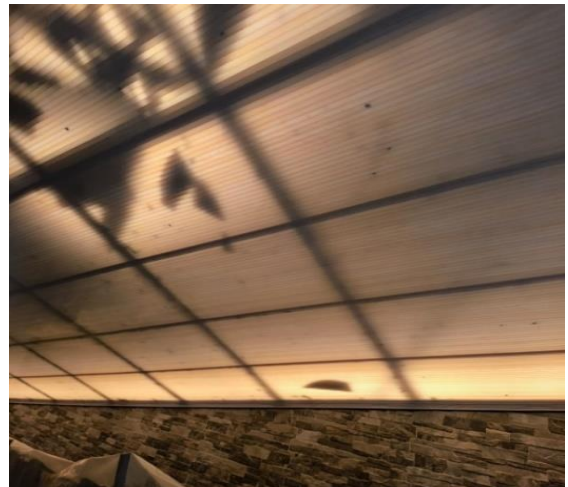
Ilustración 10. Vista desde el interior del daño en el tejado.
