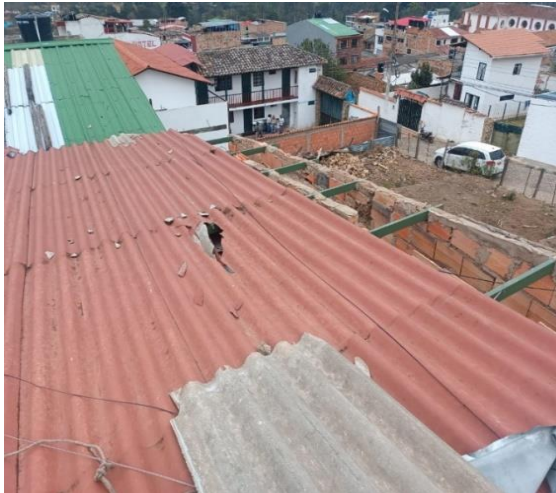
Ilustración 9. Daño en el tejado de la biblioteca
