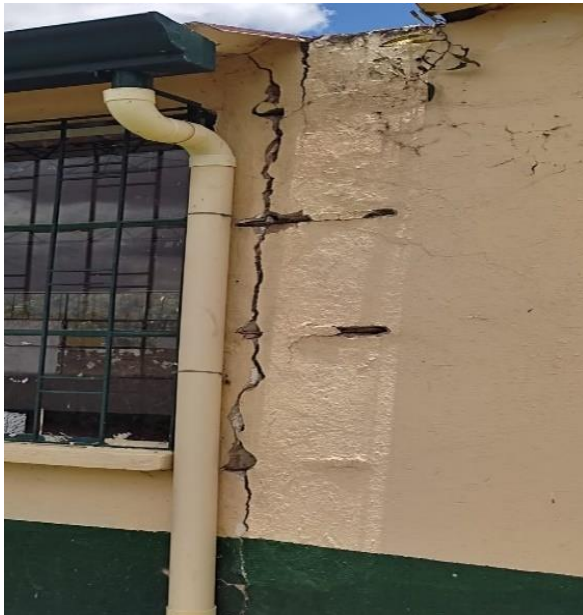
Ilustración 19. Falla estructural en muro
