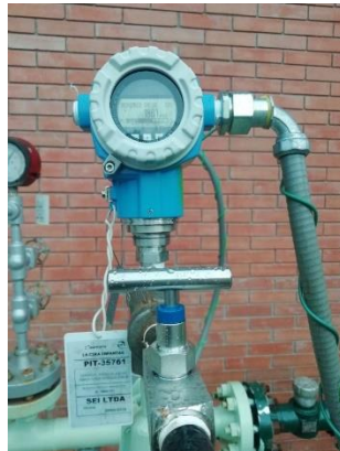
Figura. 19 Transmisor indicador de presión (FIT) Fuente: Autor
