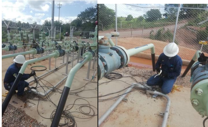
Figura. 29 Conexión de transmisores a tablero de control Fuente: Autor
