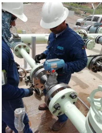
Figura. 20 Transmisor indicador de flujo instalación Fuente: Autor
