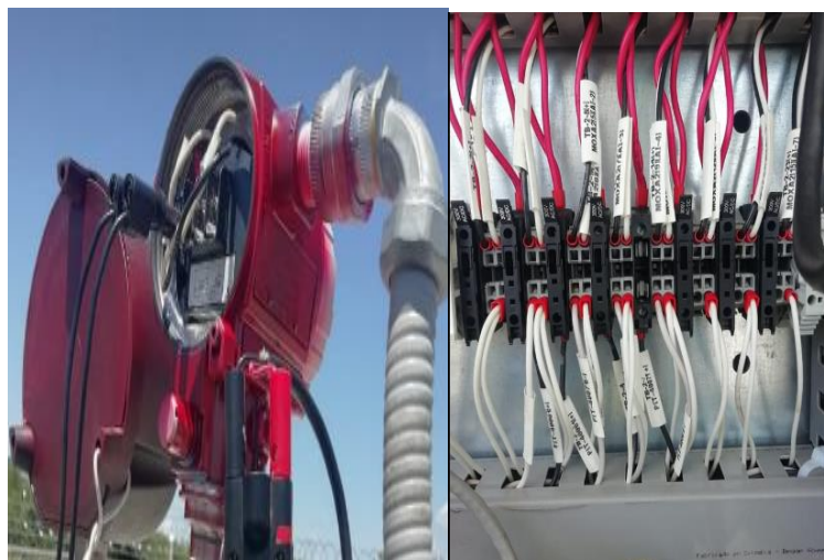
Figura. 30 Conexión de transmisores a tablero de control Fuente: Autor
