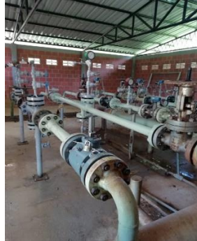
Figura. 5 Manifold productor de petróleo Fuente: Autor
