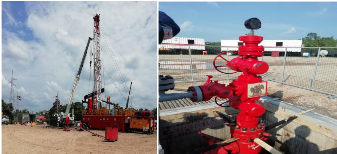
Figura. 22 Bombas de extracción y perforación de pozo petrolero Fuente: Autor
