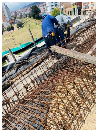
Corrección de los desplomes en el bordillo sur
