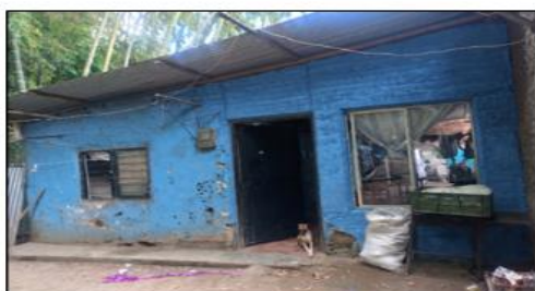
Figura 1. Inspección visual y delimitación del área de estudio. Se identifican las condiciones higrotérmicas críticas del paramento de tapia pisada.
