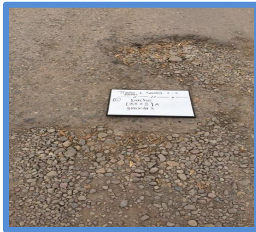
Fotografía 25 Falla12: Bache. Foto tomada por los autores del estudio.
