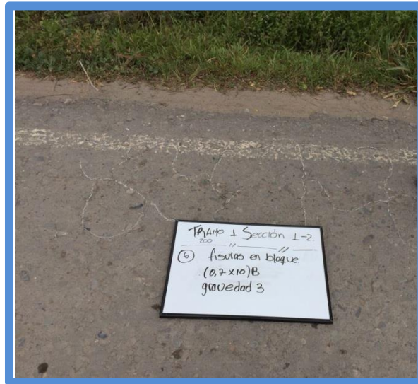
Fotografía 16 Falla 3: Piel de Cocodrilo. Foto tomada por los autores del estudio.
