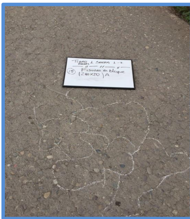
Fotografía 28 Falla 15: Piel de Cocodrilo. Foto tomada por los autores del estudio.
