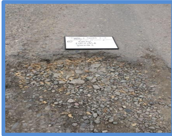
Fotografía 18 Falla 5: Bache. Foto tomada por los autores del estudio.
