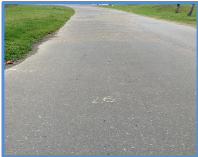
Fotografía 37 Falla 26: Desgaste Superficial. Foto tomada por los autores del estudio.
