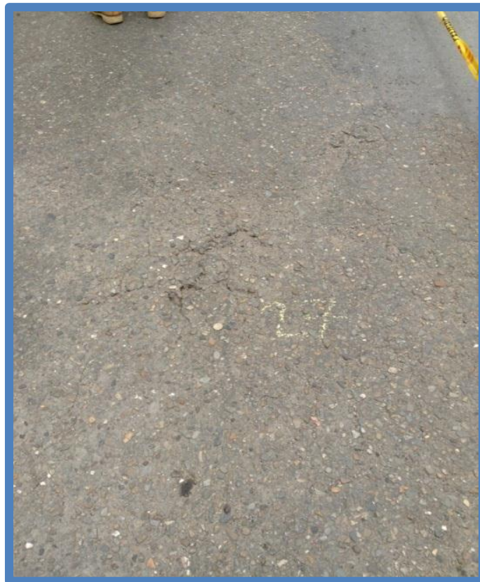
Fotografía 38 Falla 27: Piel Cocodrilo. Foto tomada por los autores del estudio.
