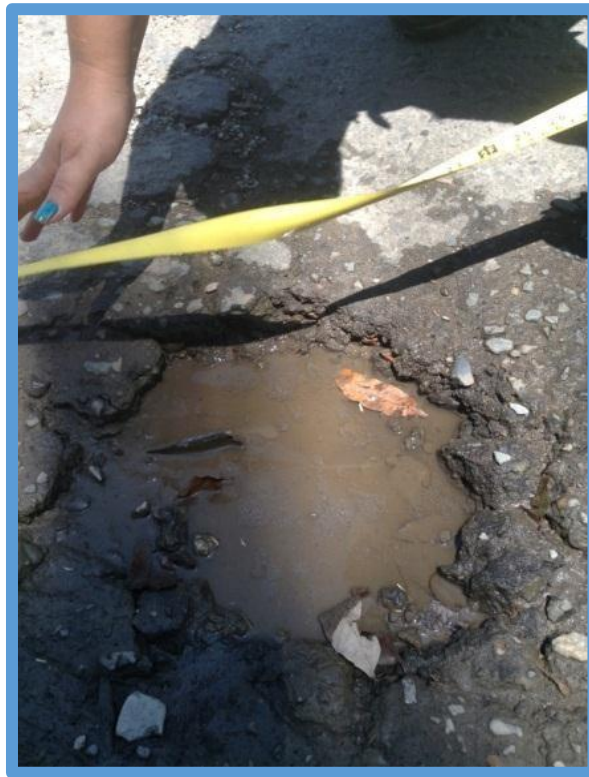
Fotografía 32 Falla 19: Bache. Foto tomada por los autores del estudio.
