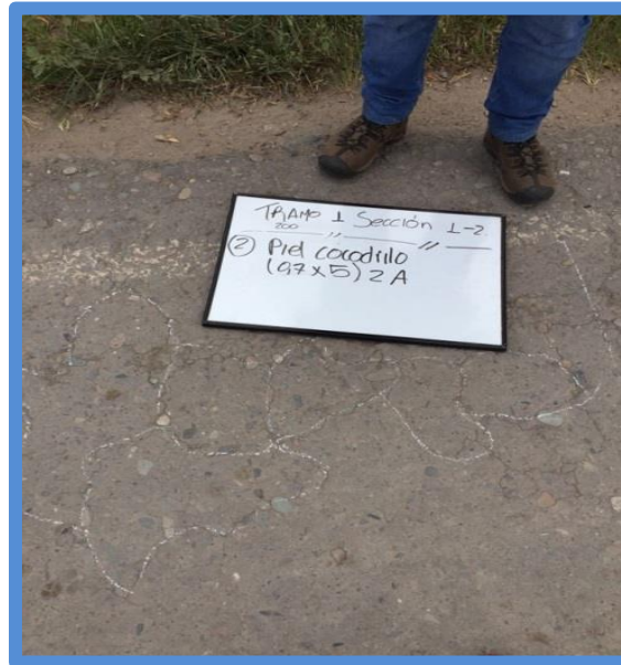
Fotografía 15 Falla 2: Piel de Cocodrilo. Foto tomada por los autores del estudio.
