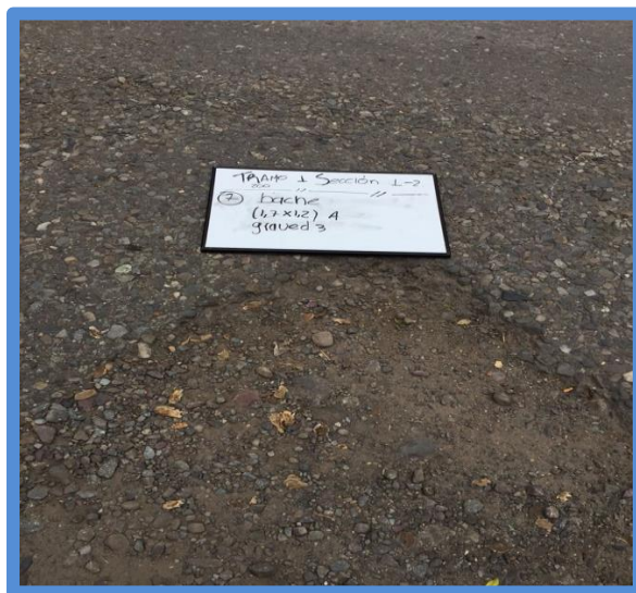
Fotografía 17 Falla 4: Bache. Foto tomada por los autores del estudio.
