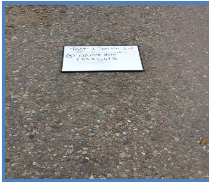
Fotografía 20 Falla7: Desgaste superficial. Foto tomada por los autores del estudio.
