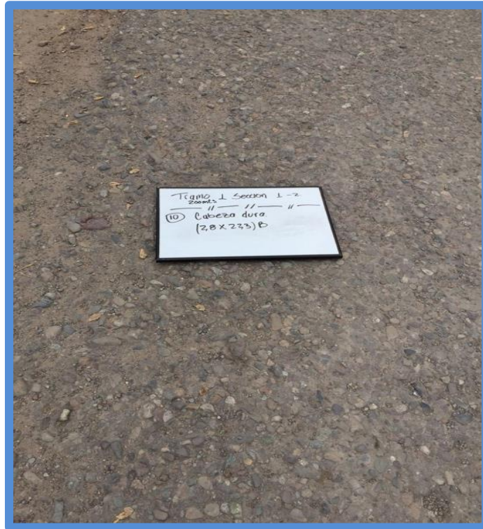
Fotografía 23 Falla 10: Desgaste superficial. Foto tomada por los autores del estudio.
