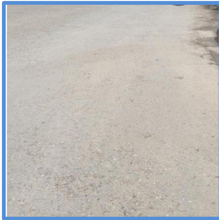
Fotografía 35 Falla 22: Desgaste Superficial. Foto tomada por los autores del estudio.
