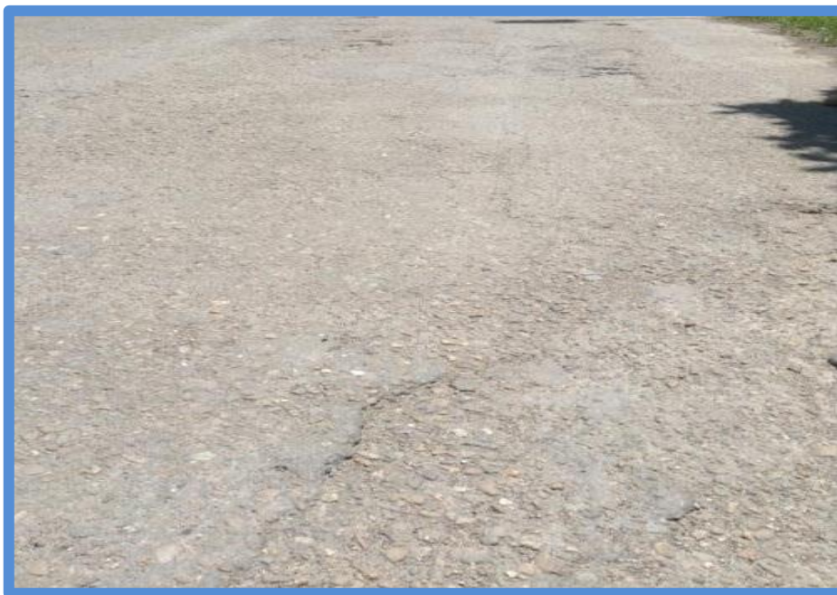
Fotografía 34 Falla 21: Desgaste Superficial. Foto tomada por los autores del estudio.
