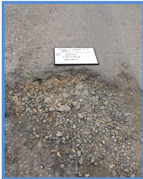
Fotografía 24 Falla 11: Bache. Foto tomada por los autores del estudio.
