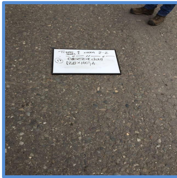
Fotografía 27 Falla 14: Desgaste superficial. Foto tomada por los autores del estudio.
