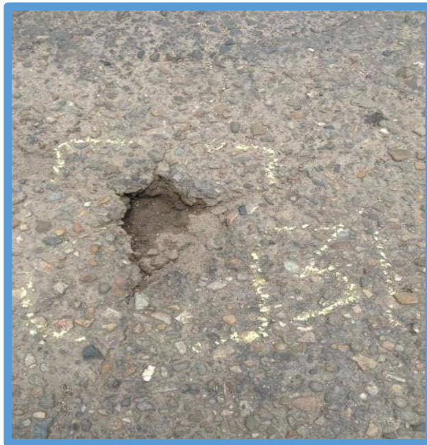
Fotografía 33 Falla 20: Bache. Foto tomada por los autores del estudio.
