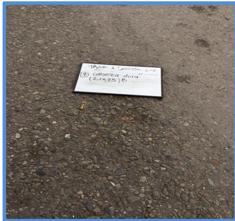
Fotografía 22 Falla 9: Desgaste superficial. Foto tomada por los autores del estudio.
