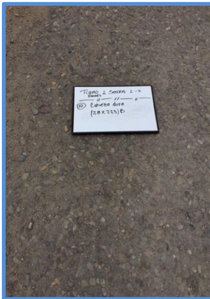
Fotografía 26 Falla 13: Desgaste superficial. Foto tomada por los autores del estudio.
