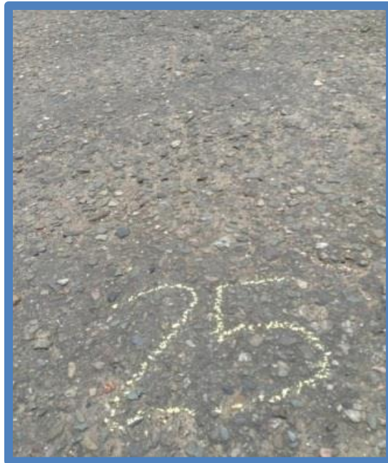
Fotografía 36 Falla 25: Desgaste superficial. Foto tomada por los autores del estudio.
