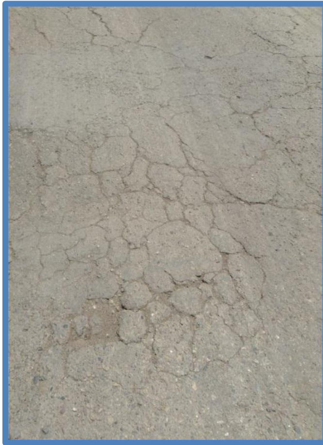
Fotografía 39 Falla 28: Piel de Cocodrilo. Foto tomada por los autores del estudio.
