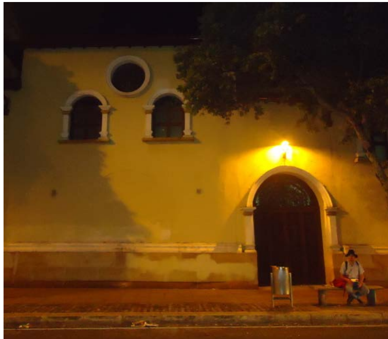
F2. Acciones vandálicas, intervenciones impropias, decoloración o mancha.
