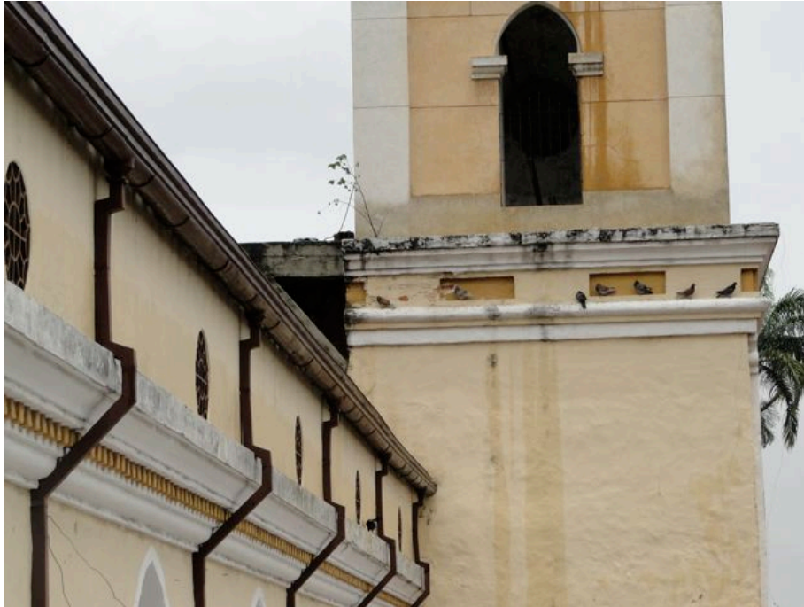
F5. Lavados, vegetación superior, ennegrecimiento, presencia de palomas, decoloración o mancha.
