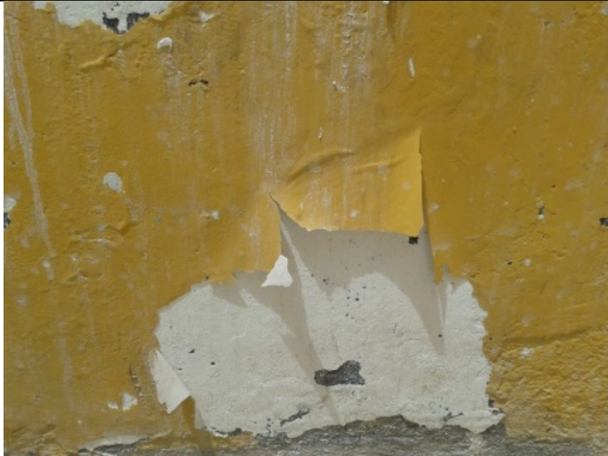
F3. Ensuciamiento, desconchado. Decoloración o mancha.
