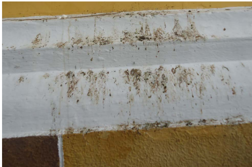
F6. Excremento de palomas, intervención impropia
