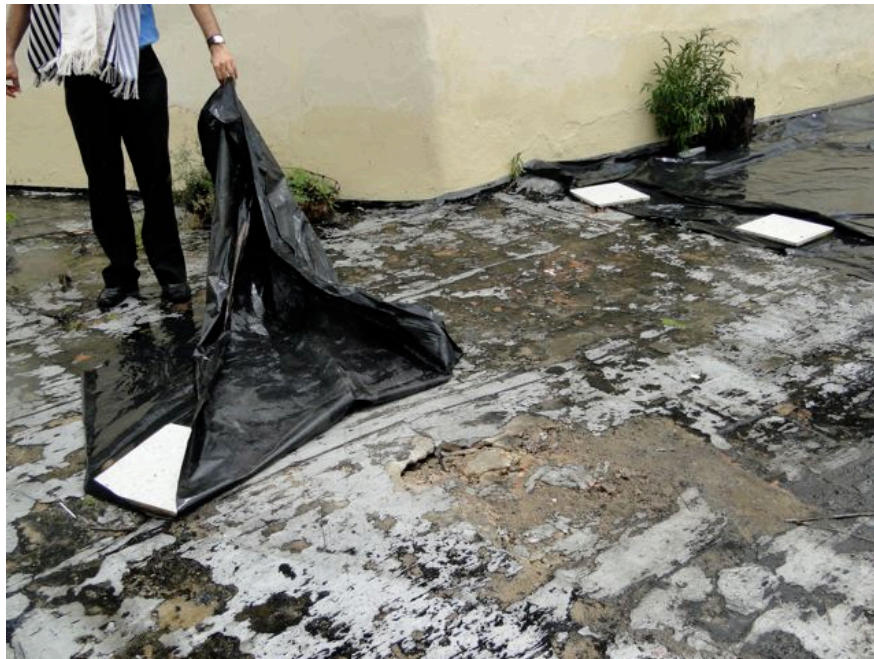
F2. Ennegrecimiento, vegetación superior, intervenciones impropias
