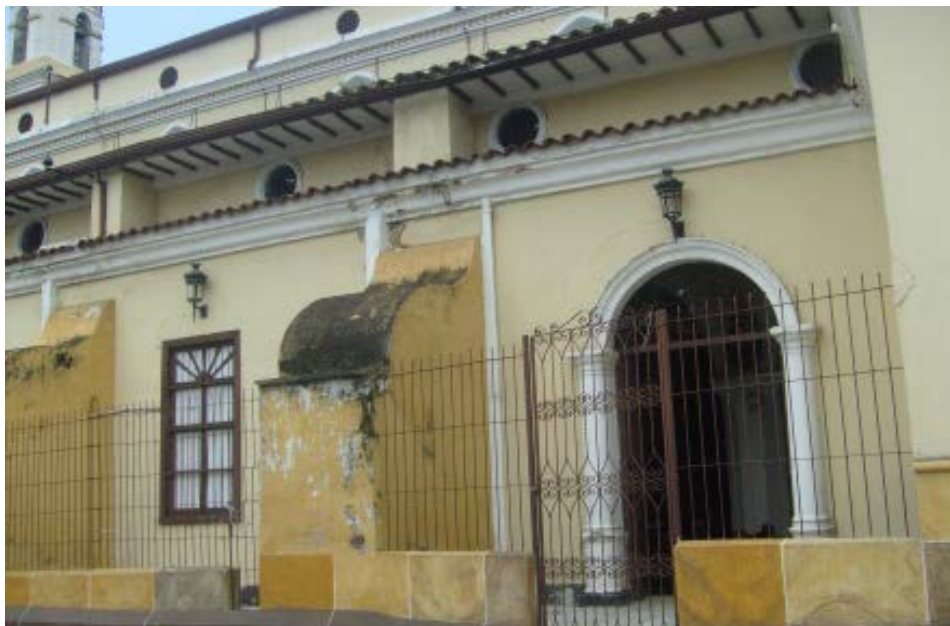
F6. Ennegrecimiento, decoloración o mancha, intervenciones impropias.
