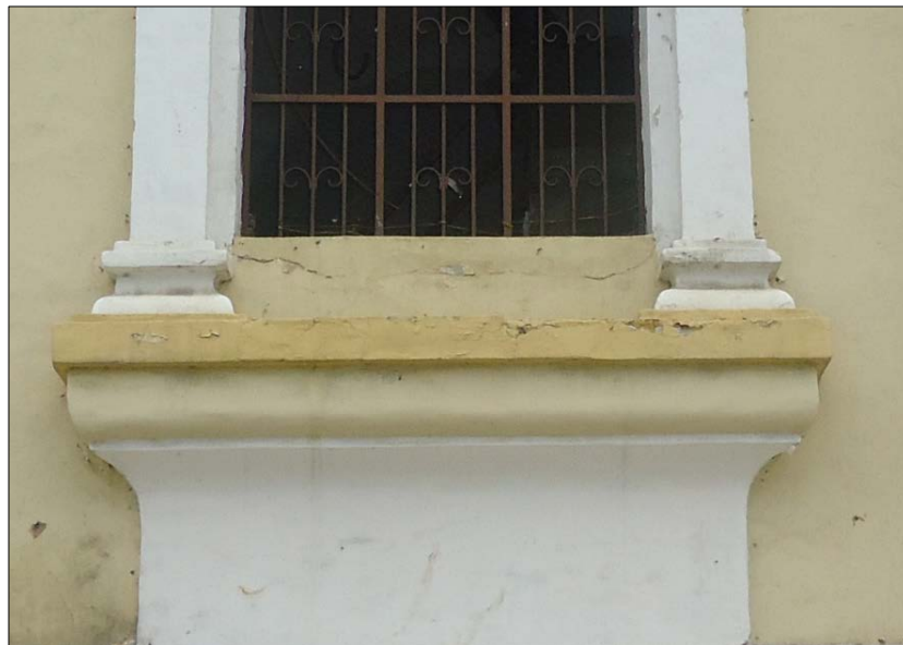
F1. Fisura, ensuciamiento, decoloración o mancha
