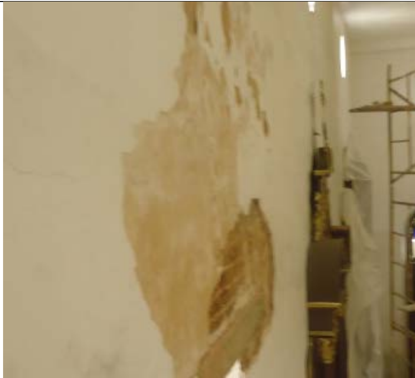
F11. Fisura, desconchado, intervención impropia
