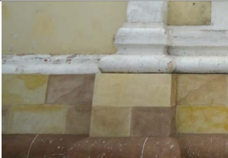
F8. Suciedad, ensuciamiento, decoloración o mancha, excremento de palomas, intervenciones impropias
