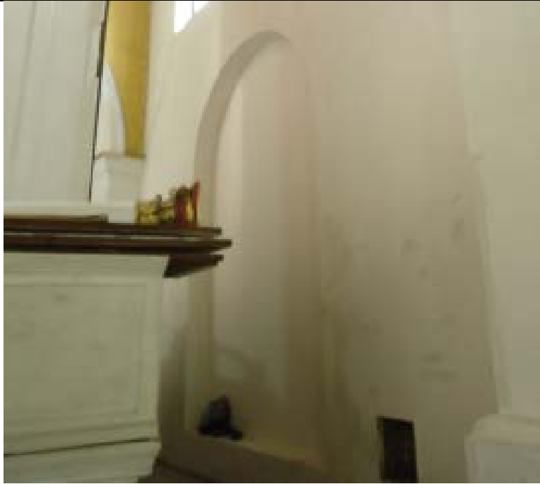
F1. Elemento impropio, intervención impropia
