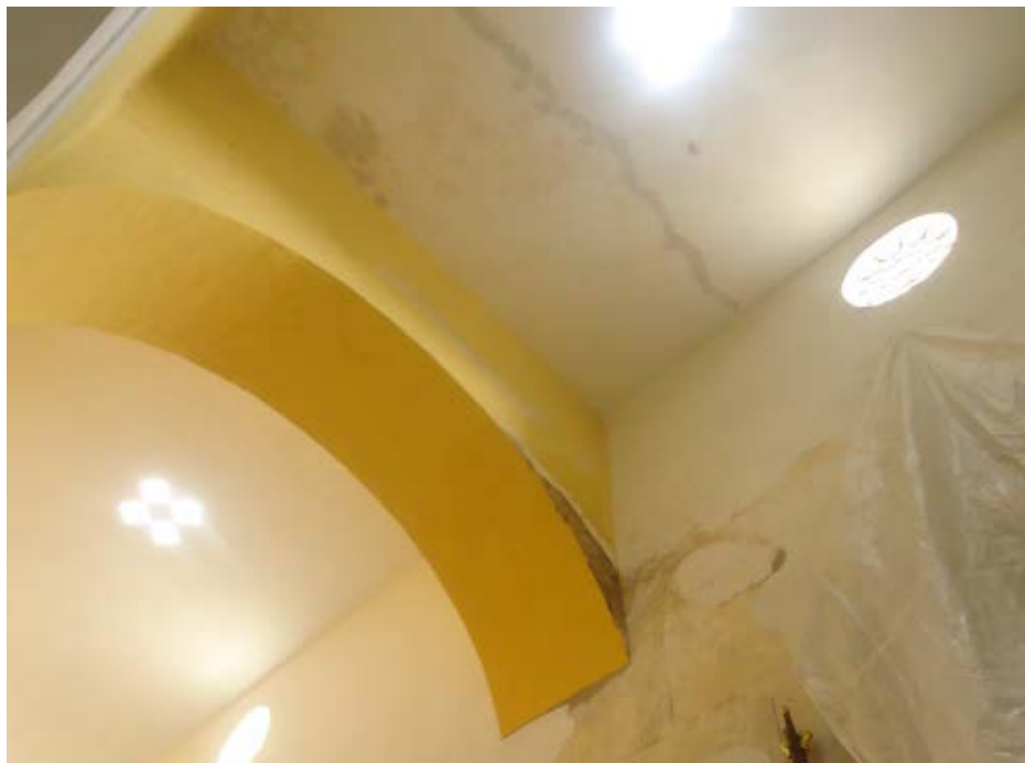
F10. Fisura, mancha desconchado.
