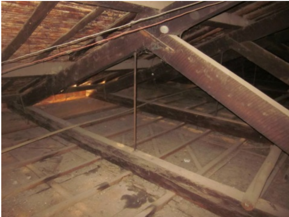
F18. Ensuciamiento, Hongos cromógenos
