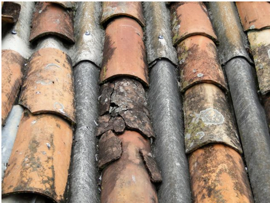
F8. Elemento impropio
