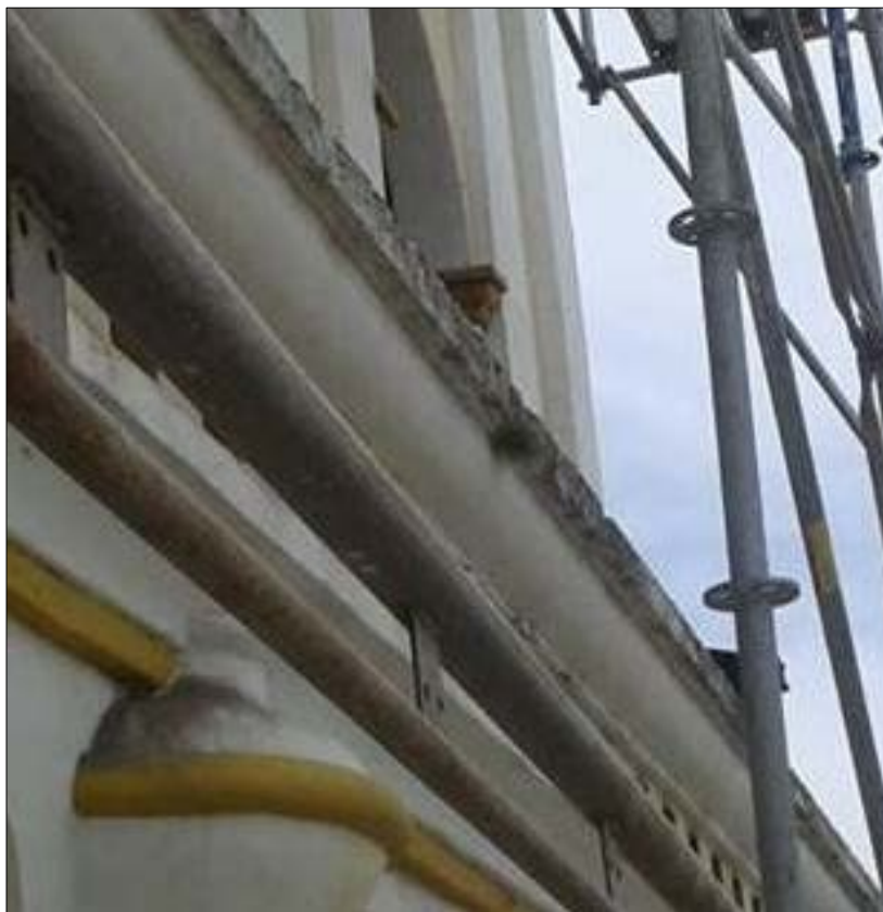
F3. Ensuciamiento, ennegrecimiento, costras desprendidas, mohos, vegetación superior, decoloración o mancha
