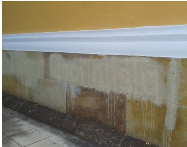
F4. Intervención impropia, acciones vandálicas, excremento de palomas.
