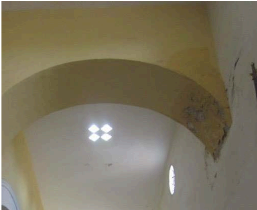
F8. Mancha, desconchado.
