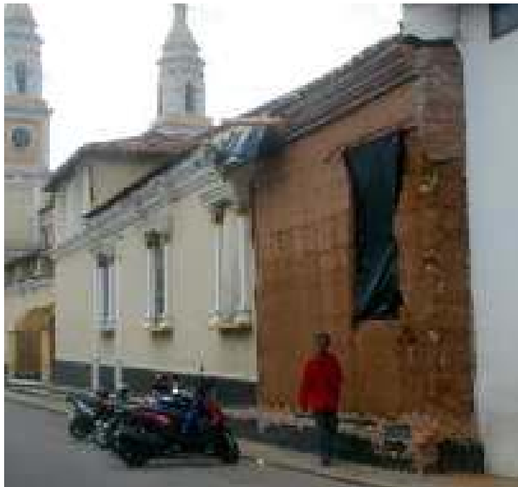
F8. Desplome, reconstrucción posterior.
