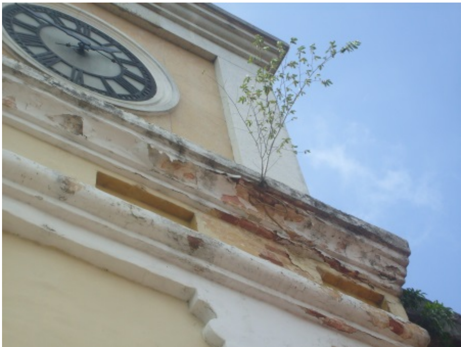
F12. Ensuciamiento, vegetación superior, desprendimiento de ornamento.
