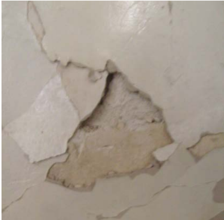
F16. Fisura, desconchado
