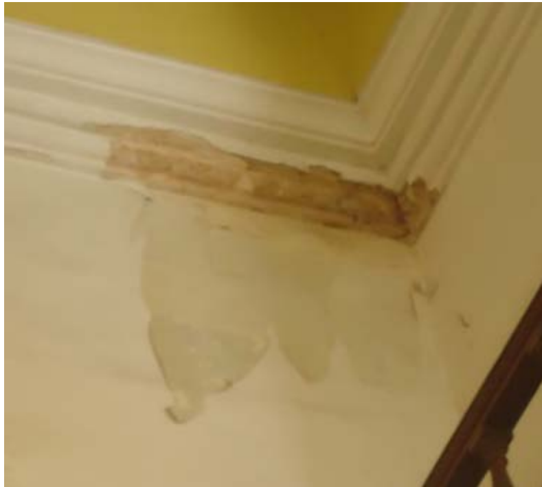
F14. Mancha, costra desprendida, desconchado
