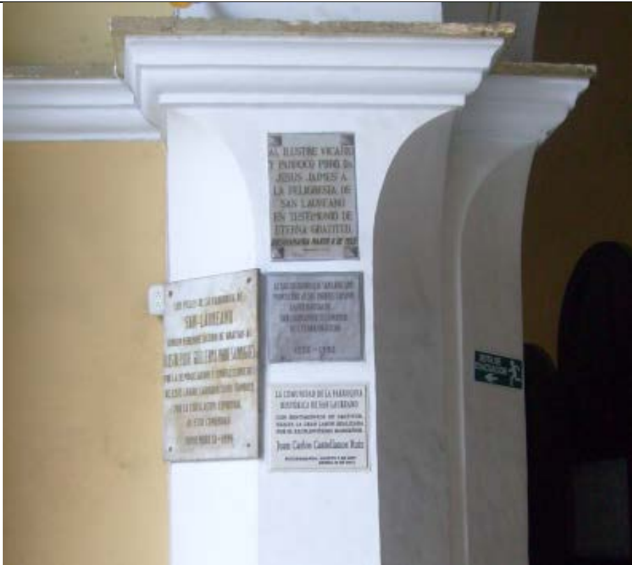
F9. Elemento impropio.
