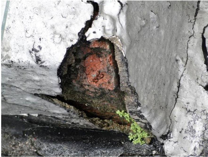
F3. Vegetación superior, fisura, ennegrecimiento, costras desprendidas, desconchado
