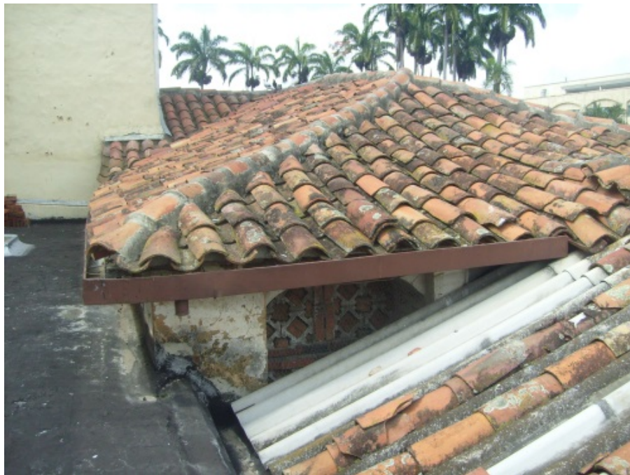
F14. Elemento impropio
