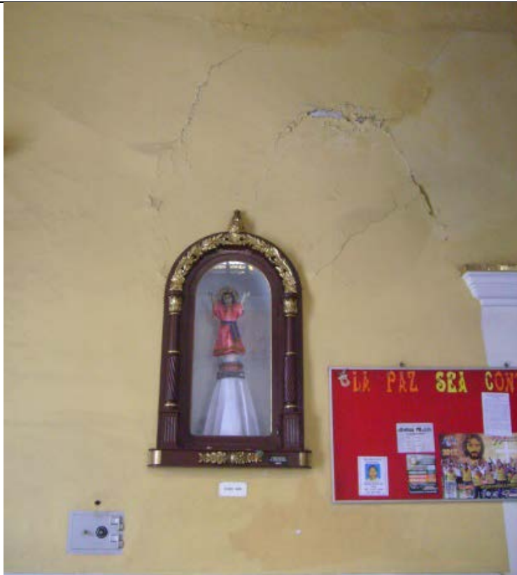
F15. Decoloración, mancha, desconchado, fisura.
