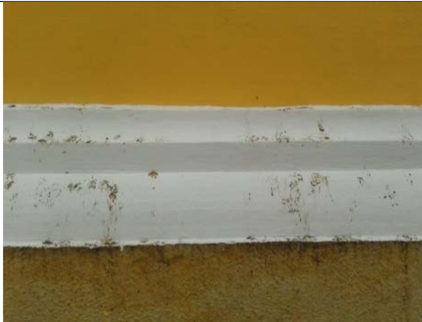
F5. Excremento de palomas, intervención impropia.
