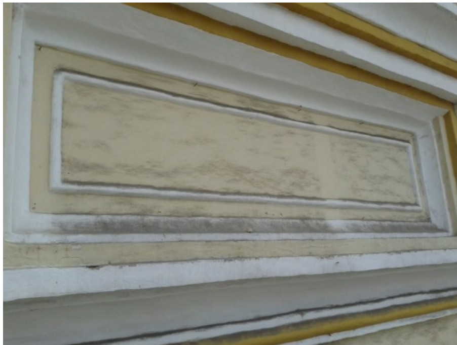
F7. Ensuciamiento, decoloración o mancha
