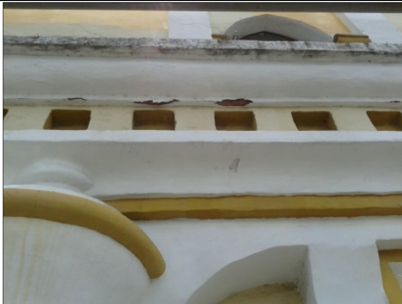
F2. Ensuciamiento, ennegrecimiento, costras desprendidas, desconchado, decoloración o mancha.
