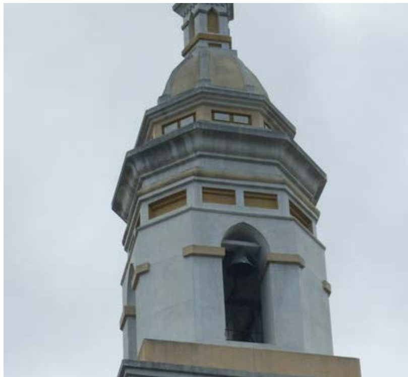
F9. Ensuciamiento, ennegrecimiento, decoloración o mancha, lavados.
