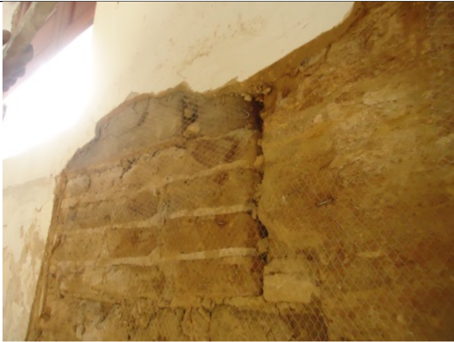
F13. Intervención impropia
