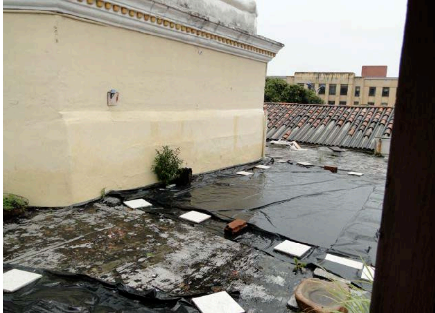
F1. Ennegrecimiento, vegetación superior, intervenciones impropias
