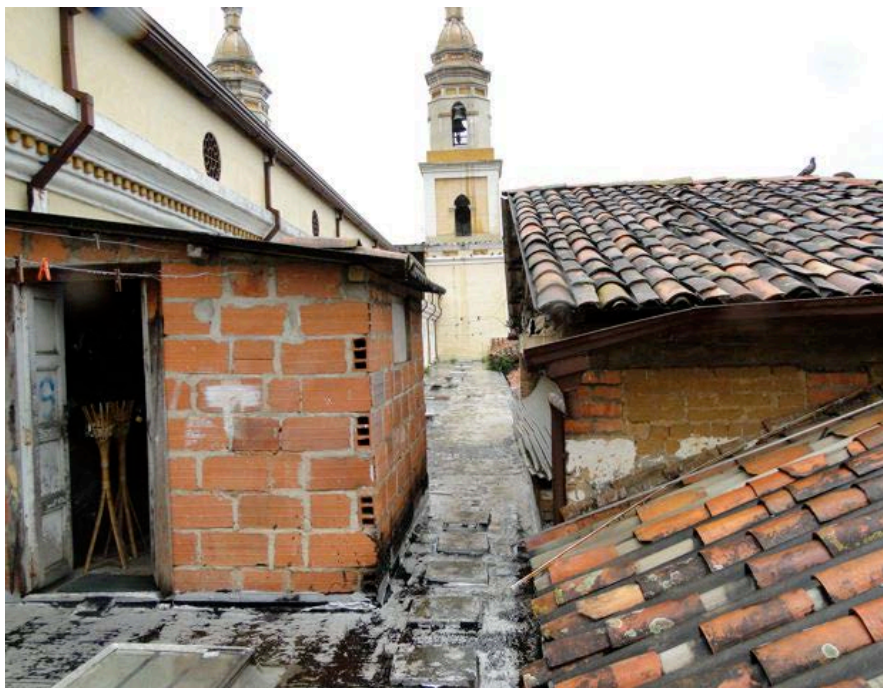
F4. Elemento impropio, ennegrecimiento, intervenciones impropias.
