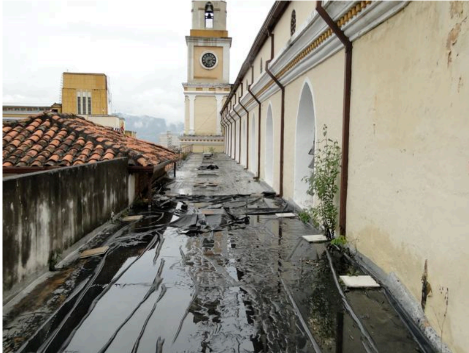
F7. Ennegrecimiento, lavado, vegetación superior, decoloración o mancha.
