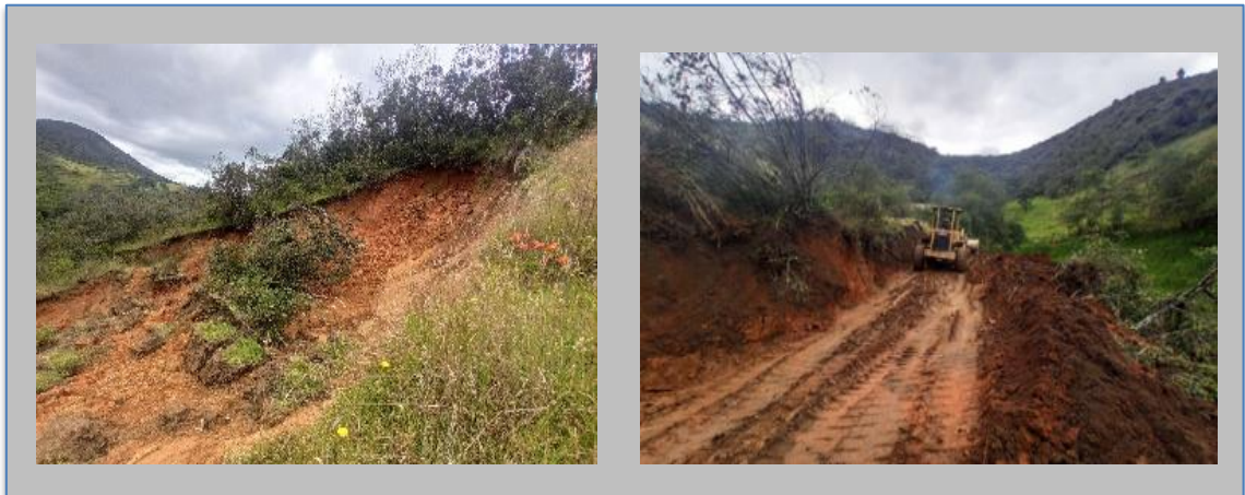
Figura 37. Asistencia a fenómeno de remoción de masa de mayor magnitud. Vereda Molino sector Culebreras.
