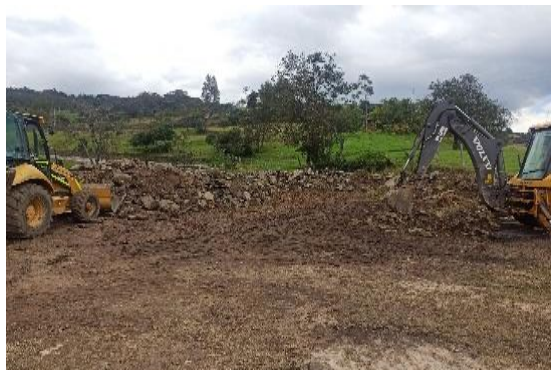
Figura 40. Depósito de escombros de asfalto. Vereda El Bosque sector Caracoles
