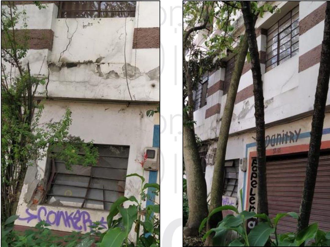
Figura 12 Registro fotográfico patologías evidenciadas.
