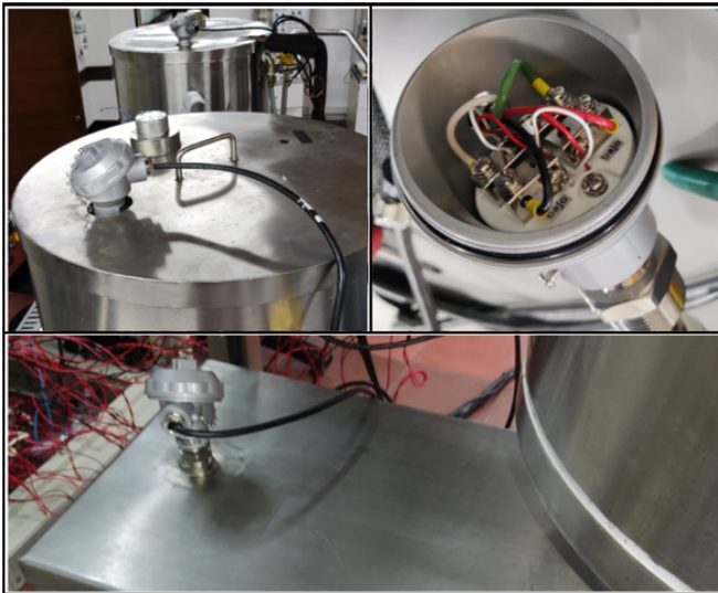
Fig. 4. Sensores de nivel multipunto instalados en tanques TK-001, TK-002 y TK-004.
