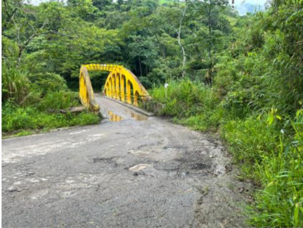
Figura 33. Deterioro de la vía. Fuente: propia
