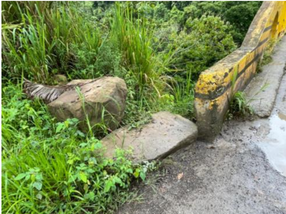
Figura 34. Caída de rocas. Fuente: propia
