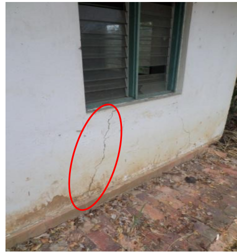
Figura No. 45 Presencia de fisuras en la mampostería
