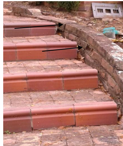
Figura No. 51 Desprendimiento de elementos de confinamiento
