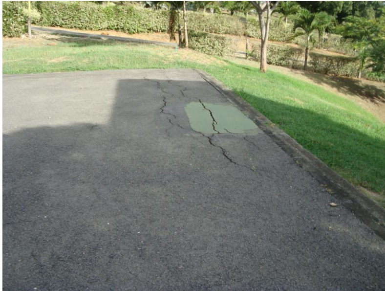
Figura No. 35 Fisuras en borde en pavimento flexible
