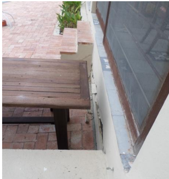
Figura No. 43 Fallas en elementos de mampostería cercano a las cimentaciones
