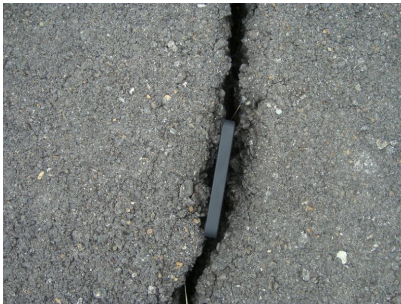
Figura No. 40 Grietas
