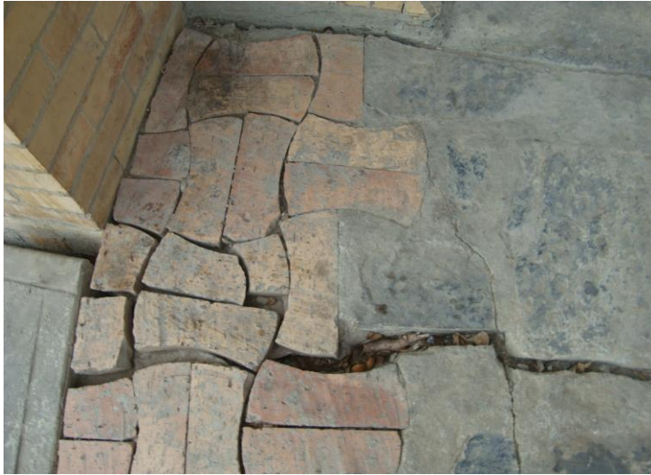
Figura No. 26 Pérdida de arena y material de mortero
