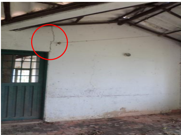
Figura No. 46 Fisuras por pérdida de rigidez
