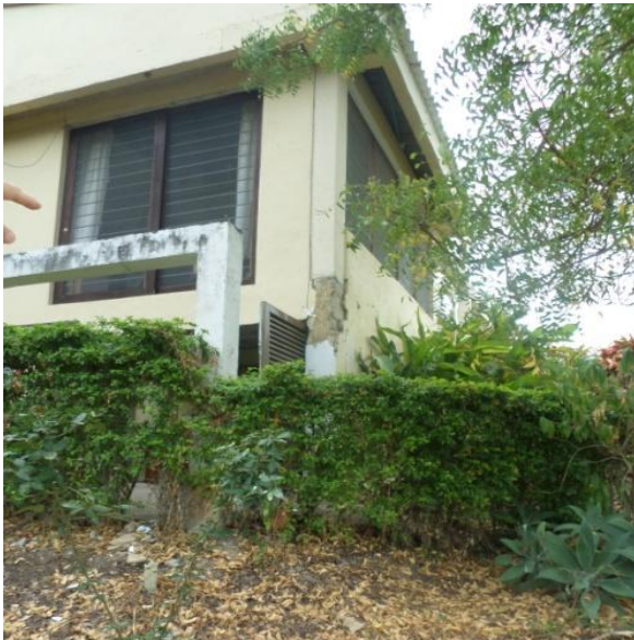
Figura No. 42 Fallas en estructura
