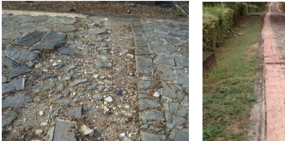
Figura No. 29 Fracturamiento de confinamiento Interno y/o externo
