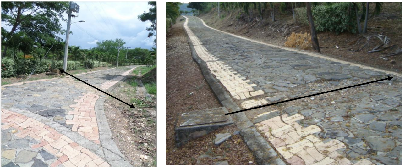
Figura No. 30 Fracturamiento por adecuación de tuberías
