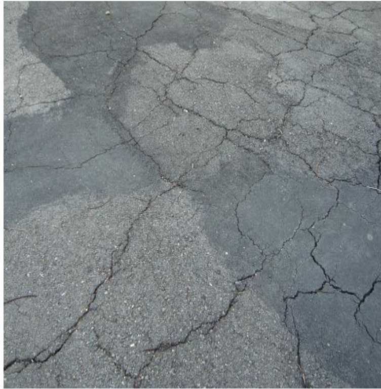
Figura No. 36 Fisuras piel de cocodrilo
