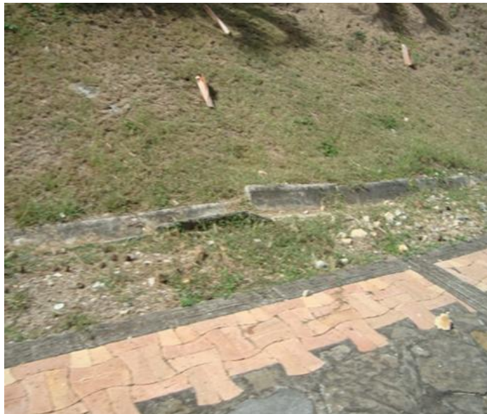
Figura No. 27 Desplazamiento de borde rompimiento de cunetas
