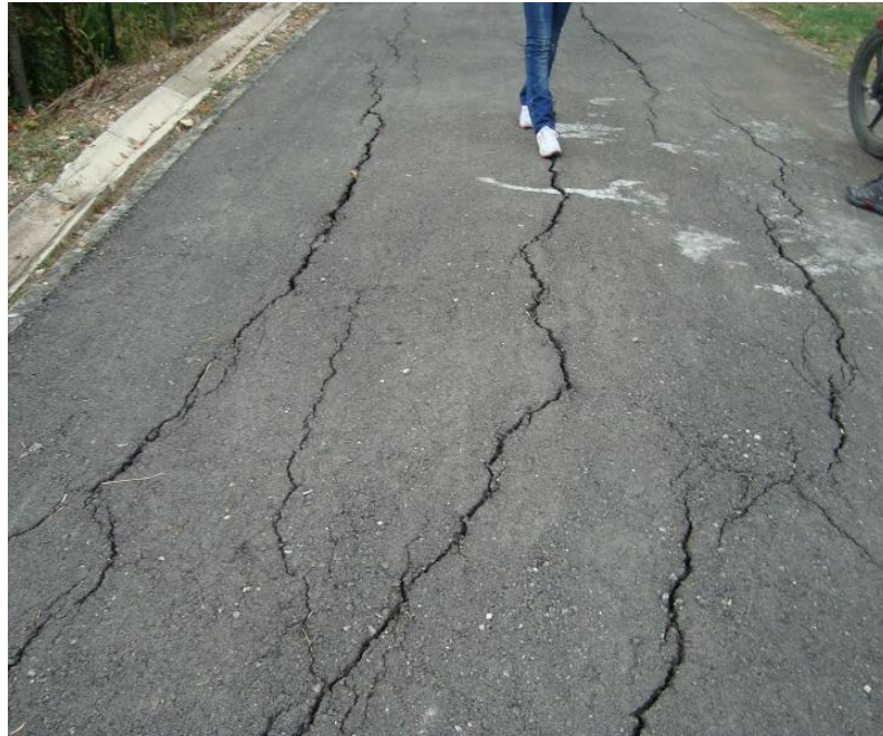
Figura No. 37 Fisuras longitudinales
