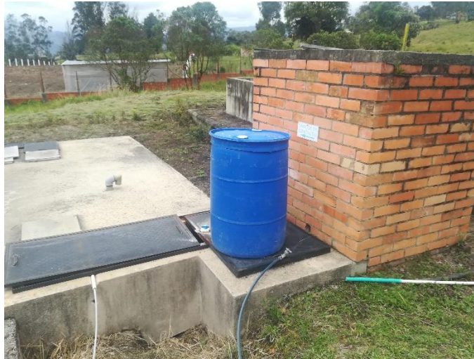
Imagen 8. Cámara de contacto
