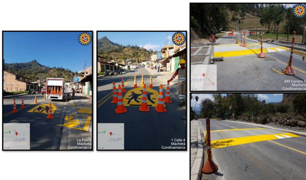
Fotografía 38. Señalización horizontal y Demarcación Vial.
