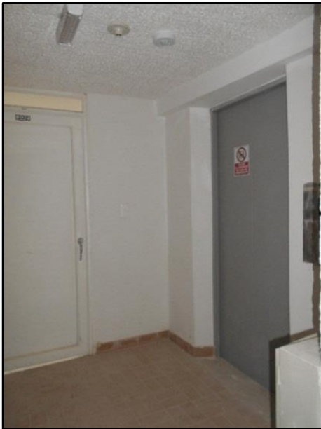
Imagen 31. Sistema de alarma y sensor de humo en uno de los pisos.
