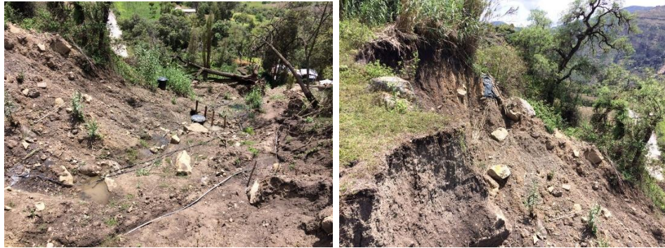
Ilustración 12 Camino de Herradura Afectado por Movimiento en Masa.
