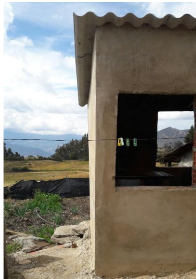
Ilustración 3 Desplome de Unidad de Cocina
