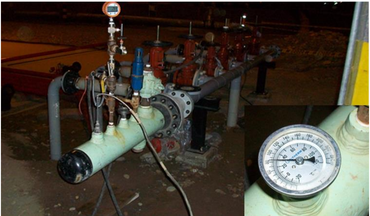
Figura 18 Banco de prueba con detalle del termómetro para prueba hidrostática
