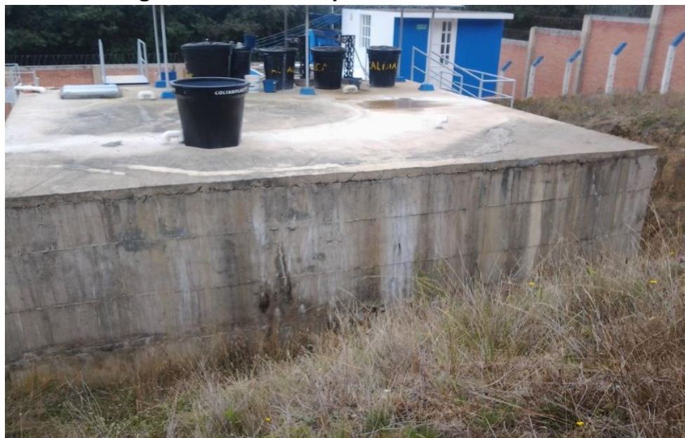
Figura 19. Vista tanque de almacenamiento
