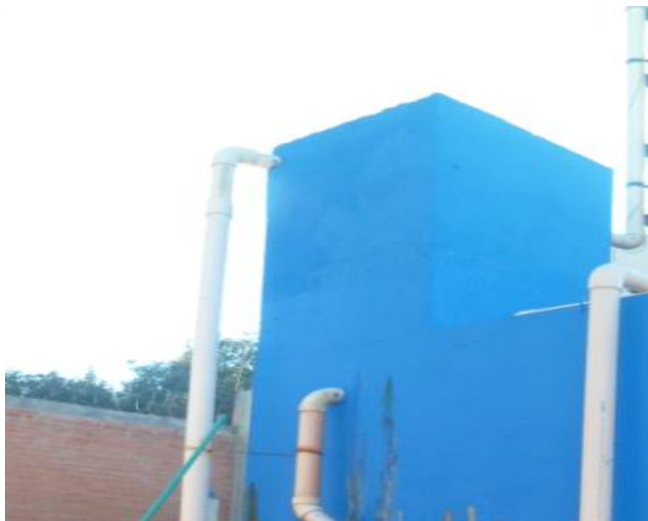
Figura 12. Vista del tanque de homogenización
