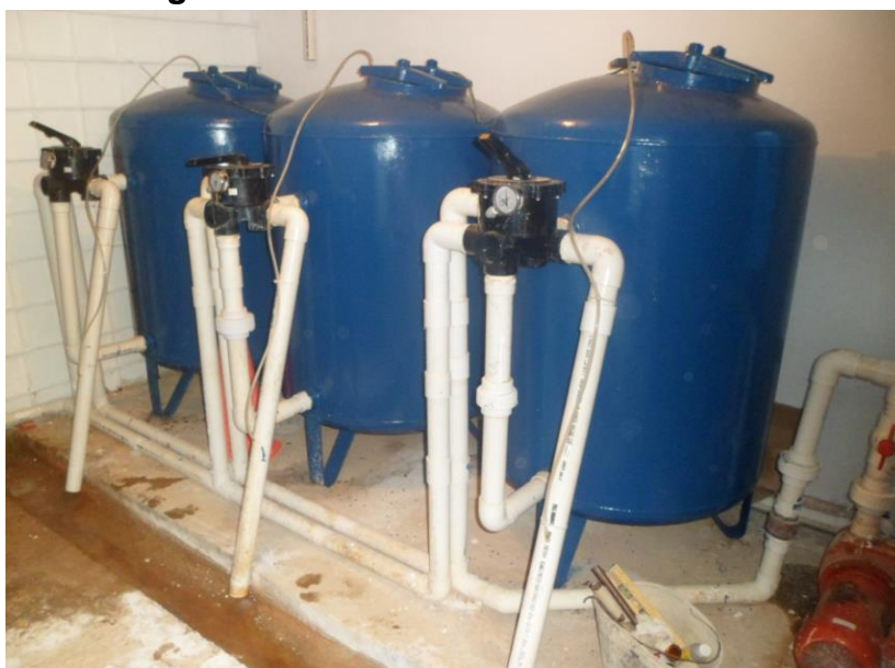
Figura 18. Vista unidades de filtración
