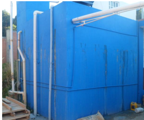
Figura 14. Vista perfil cámara de coagulación
