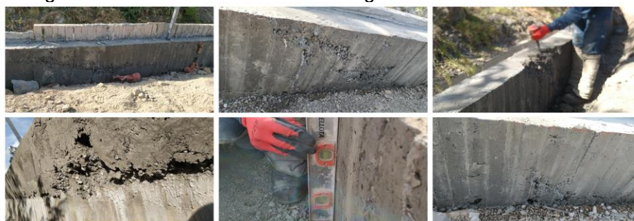
Figura 40. “Fallas de fabricación en viga de confinamiento”
