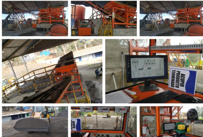
Figura 19. “Planta mezcladora (Planta de prefabricados)”
