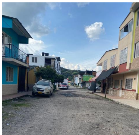
Ilustración 8.2. Calle 42 sur 37, estado actual en afirmado
