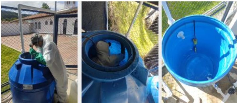
Ilustración 7: Lavado tanque de prefiltración 1, prefiltración 2, tanque CIP y agua tratada
