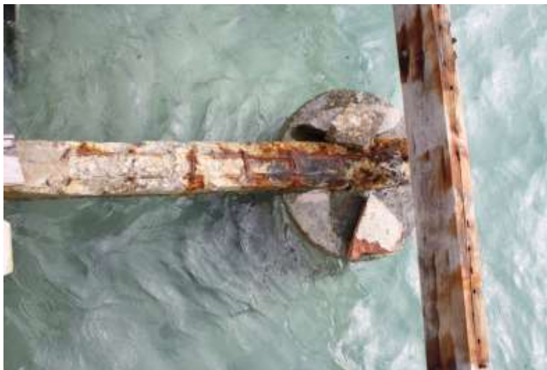
Figura 5. Ataque por sulfato en el concreto
