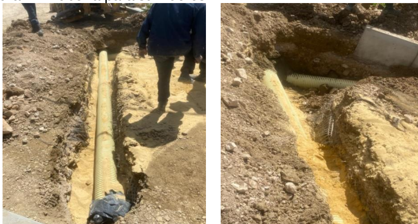
Figura 27. Tubería para sumideros
