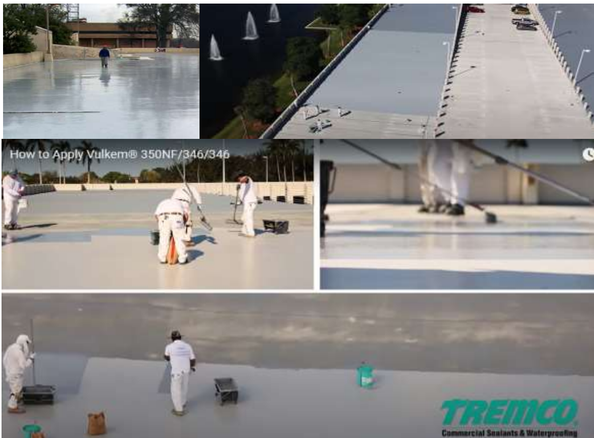
Foto de aplicación de membrana de poliuria. Tomado de How to Apply Vulkem® 350NF/346/346. https://www.youtube.com/watch?v=2M2Ssy8_7Lg
