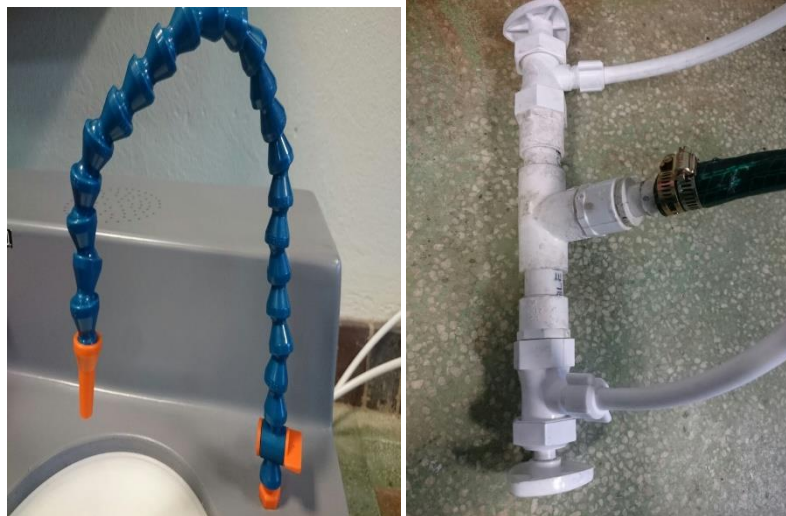
Figura 47. Manguera y válvulas.
