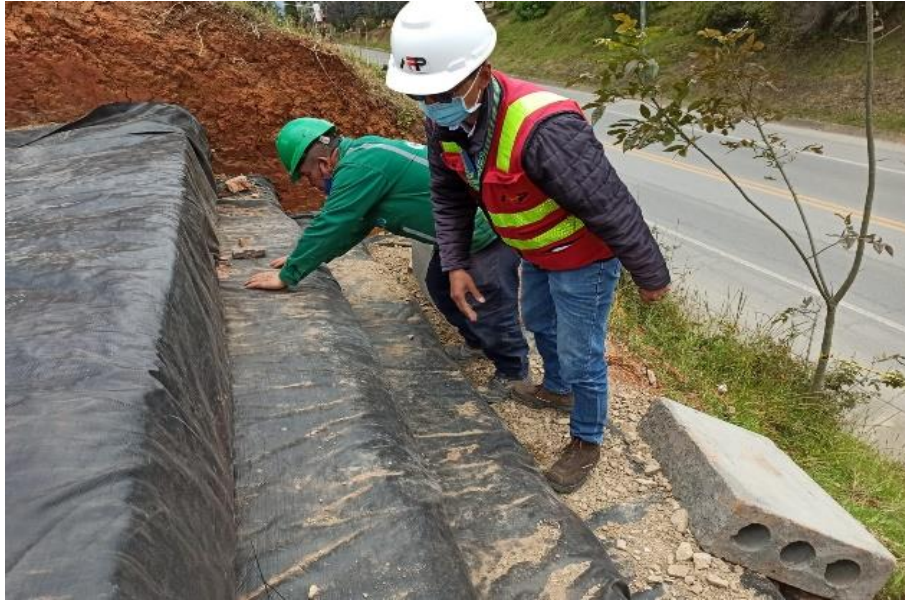
Figura 14. Revisión de capas del muro en tierra armada
