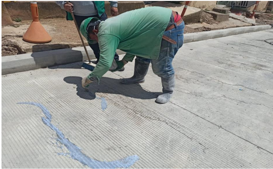
Figura 75. Fisuras en el concreto
