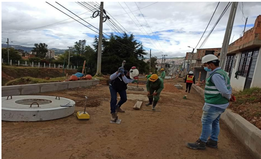
Figura 38. Instalación densímetro nuclear
