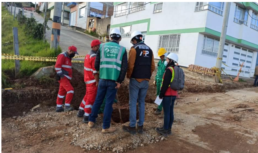
Figura 17. Visita de Veolia por daño en la red de acueducto
