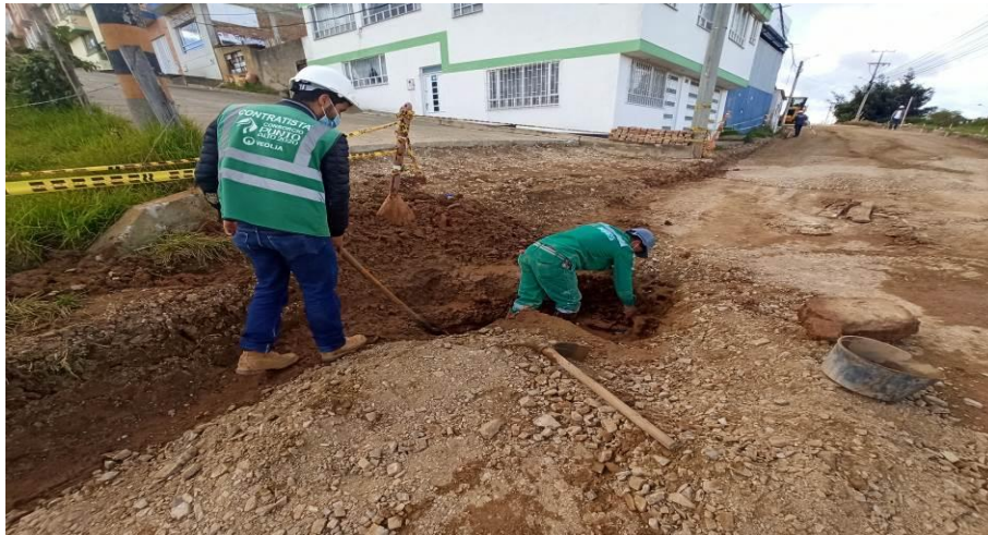
Figura 16. Apique para encontrar daño en la red
