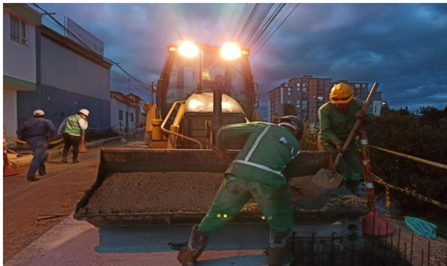
Figura 26. Solado sumidero combinado ABS (K0+155)
