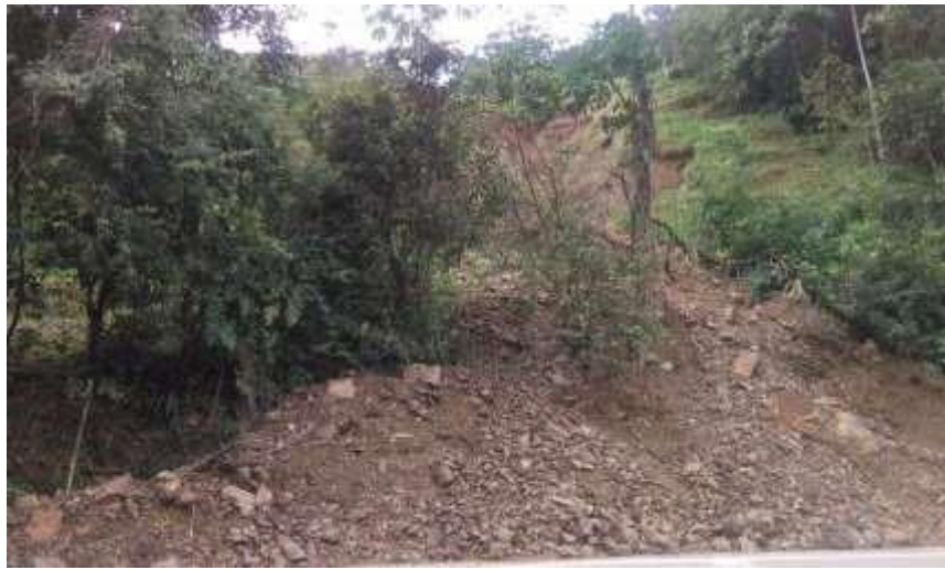
Figura 15. Material desprendido en el talud de muestreo. Fuente: Juan Arévalo, 2018.
