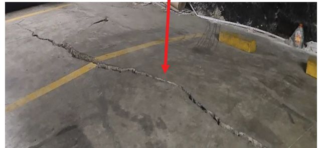
Foto 3. Grieta en placa sótano
