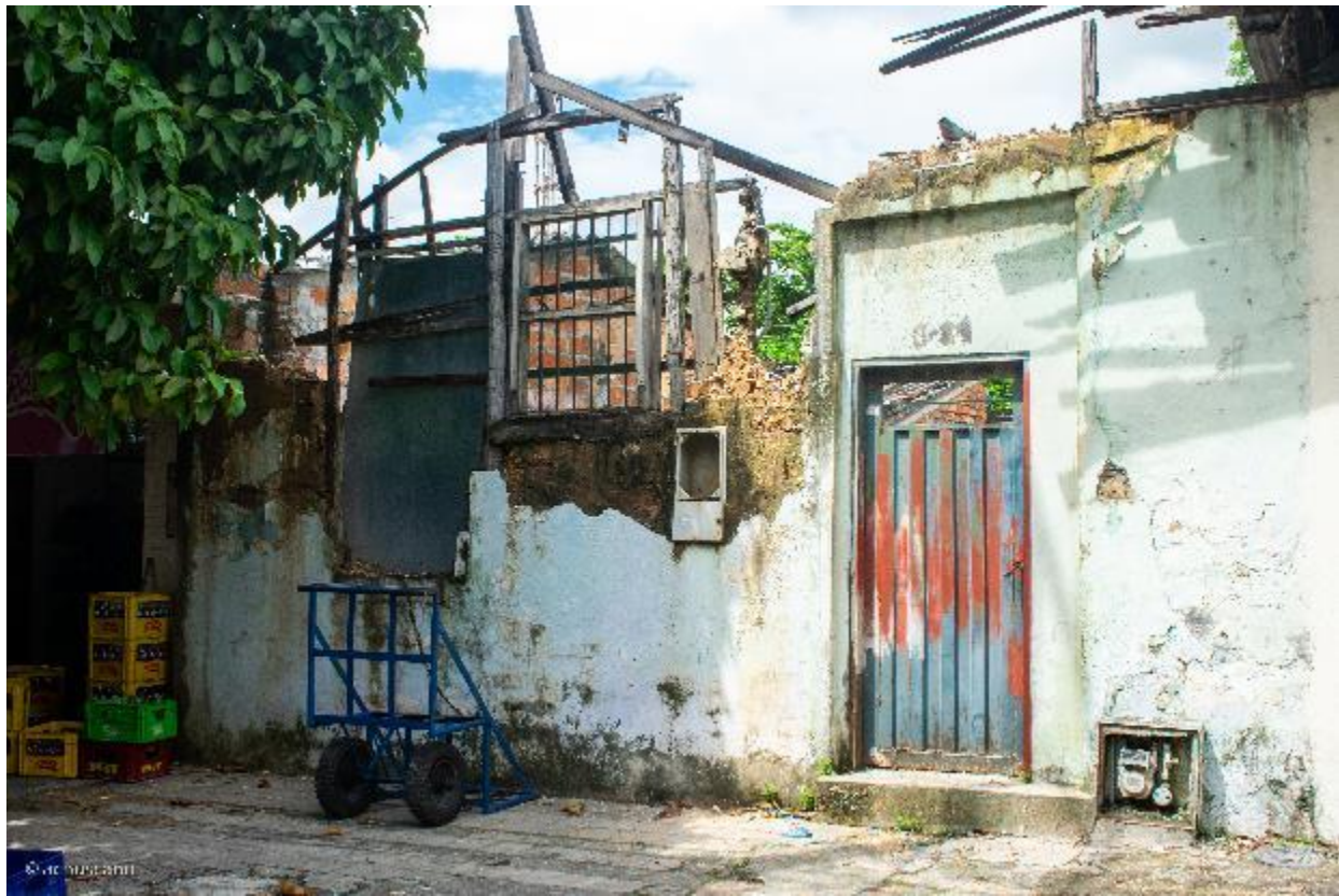
Figura 74. Muestra de deterioro físico en la Zona A, 2018
