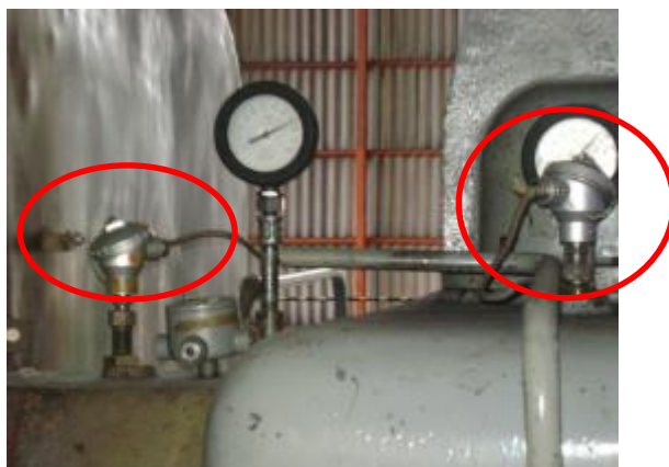
Imagen 81 Termocuplas turbina unidad 1 Termopaipa.
