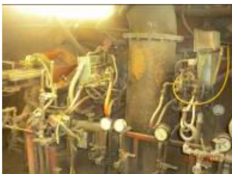
Imagen 97 Quemador e ignitor unidad 2 Termopaipa
