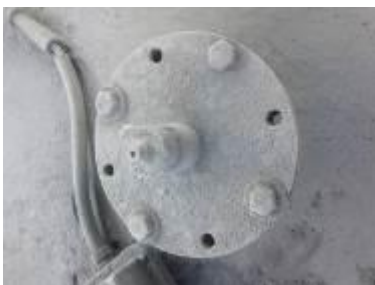
Imagen 106 Facilidad mecánica transmisor de nivel techo silo
