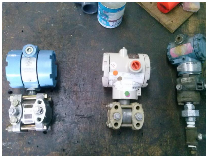
Imagen 101 Transmisores de presión para monitoreo sistema de transporte de ceniza
