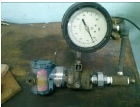
Imagen 105 Transmisor de presión para sistema de transporte de ceniza unidad 1
