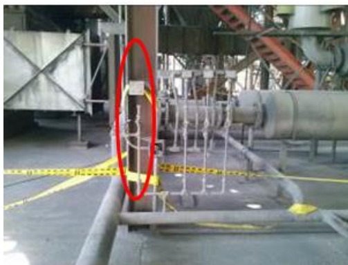
Imagen 103 Lugar de instalación de transmisor de presión unidad 3
