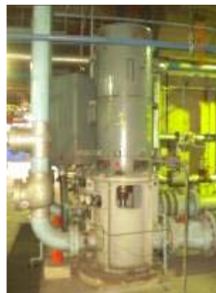
Imagen 74 Motobomba de condensado unidad 2 Termopaipa
