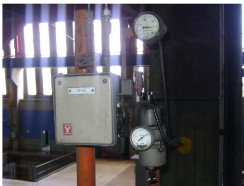
Imagen 85 Transmisor neumático de nivel Termopaipa
