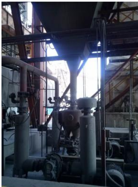
Imagen 104 Ubicación transmisor sistema de transporte de ceniza unidad 1
