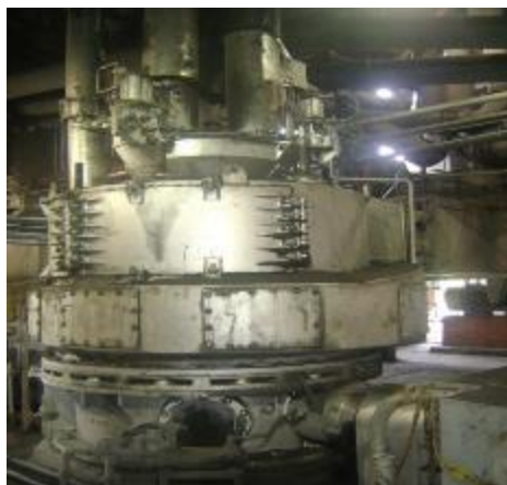
Imagen 94 Pulverizador de carbón Termopaipa
