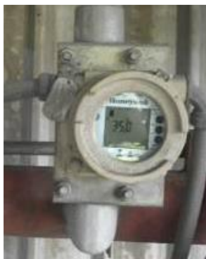
Imagen 82 Transmisor de temperatura Termopaipa
