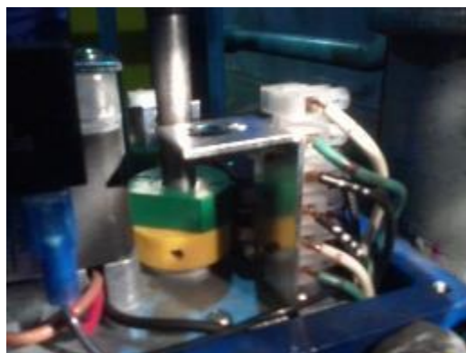
Imagen 25 electroválvula vista lateral
