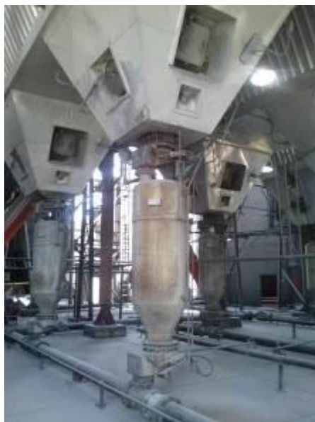
Imagen 5 Sistema de transporte de ceniza Termopaipa
