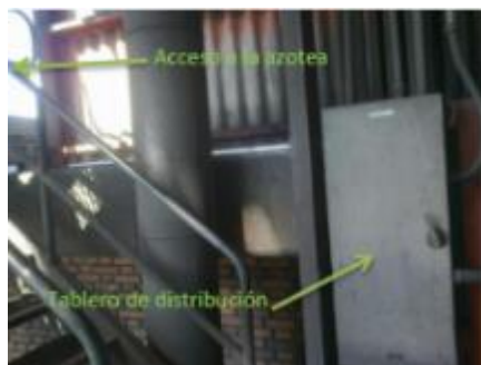
Fotografía 4. Tablero de distribución eléctrica
