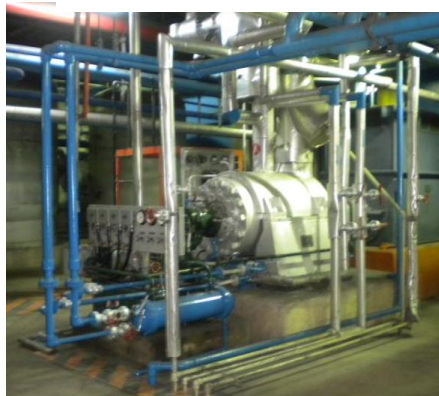
Imagen 76 Motobomba agua de alimentación Termopaipa
