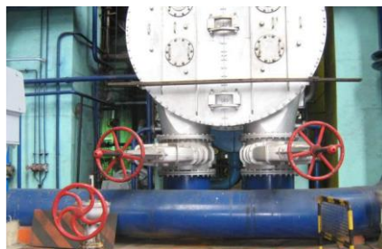
Imagen 73 Condensador unidad 1 Termopaipa
