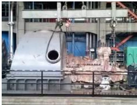
Imagen 77 Turbina unidad 2 Termopaipa
