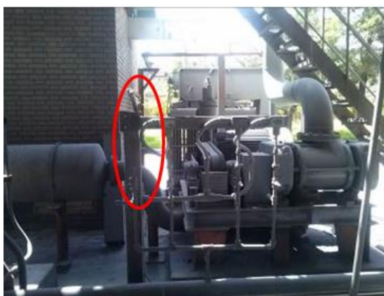
Imagen 102 Lugar de instalación de transmisor de presión unidad 3
