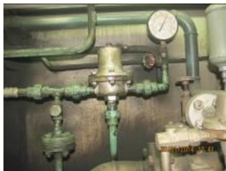
Imagen 80 Manómetro. Estación de regulación de ACPM. Termopaipa
