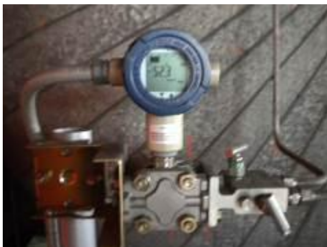
Imagen 86 Transmisor de nivel, domo caldera unidad 1 Termopaipa.
