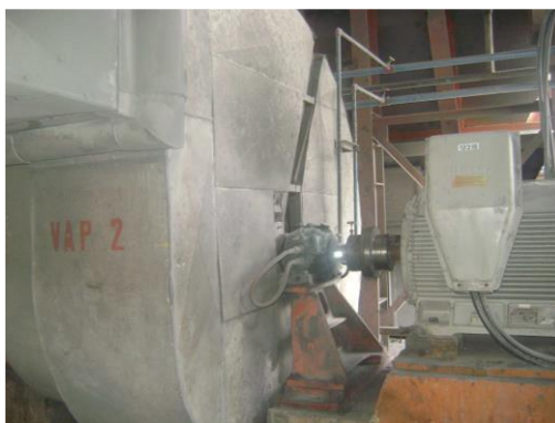
Imagen 96 Ventilador de aire primario 2, unidad 3 Termopaipa.
