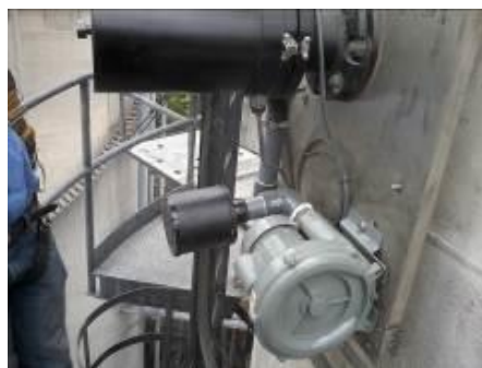
Imagen 110 Reconocimiento y mantenimiento de sensor de opacidad en chimenea de la unidad 2
