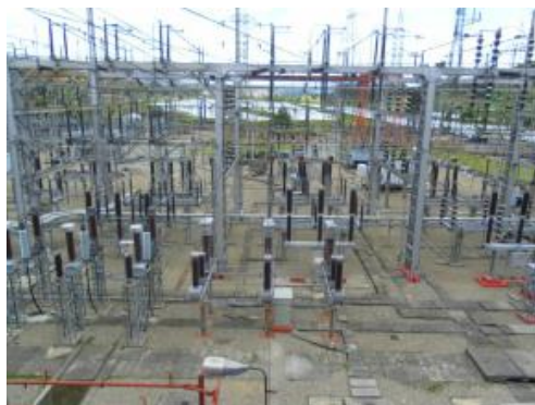
Imagen 98 Bahía de 115.000 V, unidad 3 Termopaipa.
