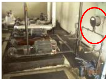
Imagen 79 Manómetro diferencial. Estación de bombeo de ACPM. Termopaipa.
