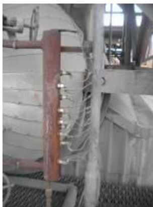
Imagen 87 Nivel de electrodos, domo superior caldera unidad 2 Termopaipa.
