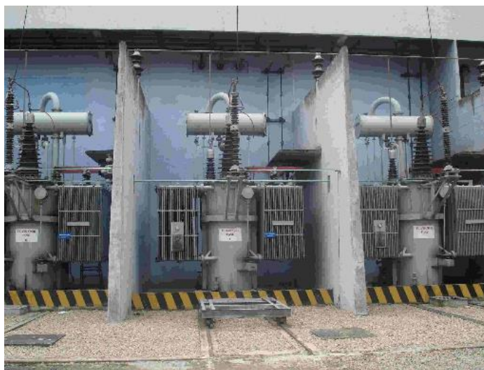
Imagen 100 Tres transformadores monofásicos de la unidad 1 Termopaipa
