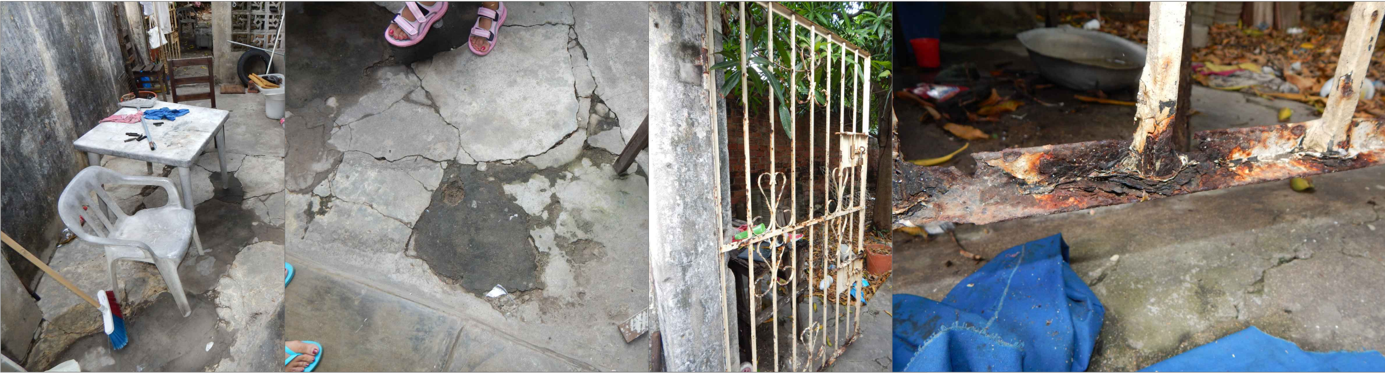
IMÁGENES 6, 7, 8 Y 9: HUNDIMIENTOS EN PLANTILLA DE RECUBRIMIENTO DE PISO DE PATIO, QUE SE EVIDENCIA EN GRIETAS TIPO MAPEO CON PÉRDIDAS DE MATERIAL CEMENTICIO, OCASIONADO POSIBLEMENTE POR BULBOS DIFERENCIALES DE PRESIÓN Y EL SUELO TIPO ARCILLA BAJO ESTA. REJA EN HIERRO FORJADO QUE SEPARA AL PATIO 1 DEL PATIO 2, PRESENTA AVANZADO ESTADO DE CORROSIÓN CON PÉRDIDAS CONSIDERABLES DE VOLUMEN POR EFECTO ÁNODO/CÁTODO.
