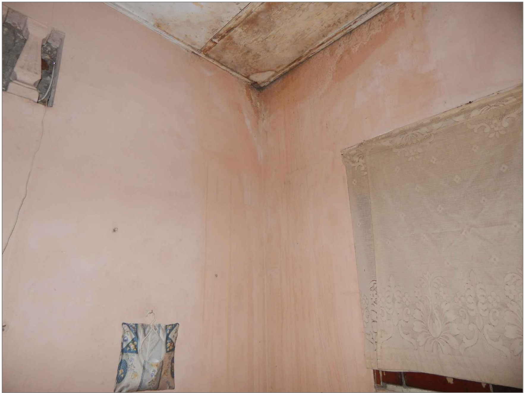
IMAGEN N° 3: HUMEDAD POR FILTRACIÓN SOBRE CIELO RASO Y MUROS QUE HA DADO LUGAR A LÍQUENES Y EFLORESCENCIAS.
