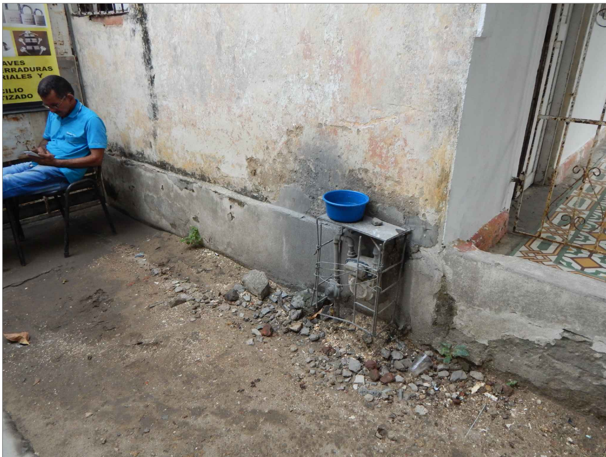
IMAGEN N° 7: HUMEDAD ASCENDENTE EN MUROS DE FACHADA
