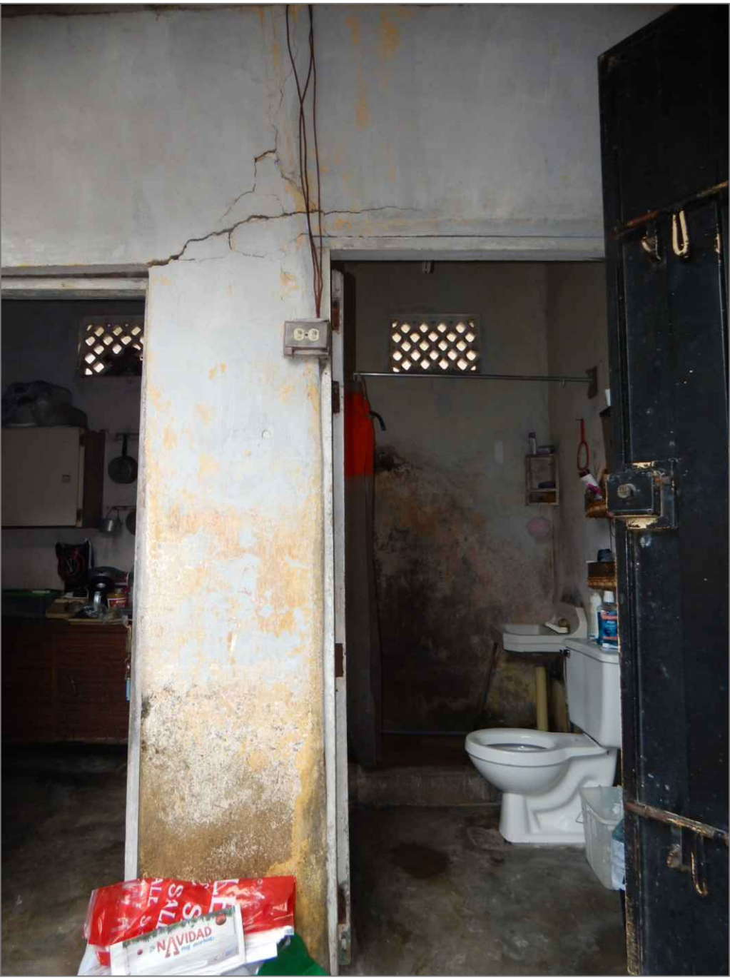
IMAGEN N° 3: VISTA GENERAL DEL ESPACIO, SE APRECIA GRIETA PASANTE EN VANO DE ACCESO DESDE BAÑO A COCINA CONTIGUA.
