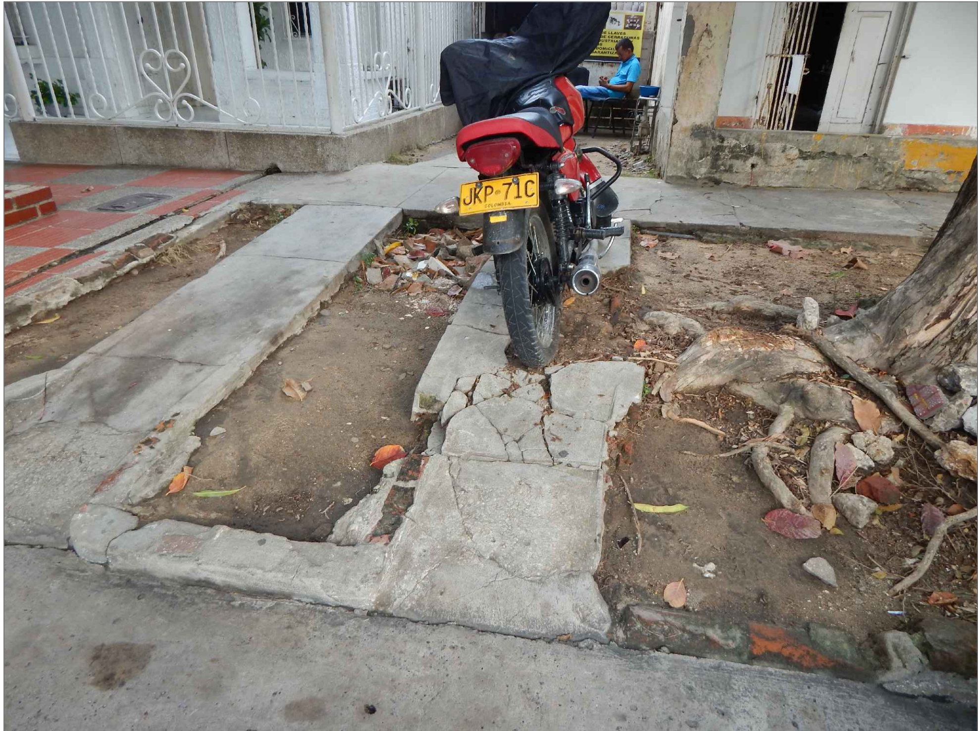
IMAGEN N° 4: ESTADO GENERAL DEL RECUBRIMIENTO DE PISO
