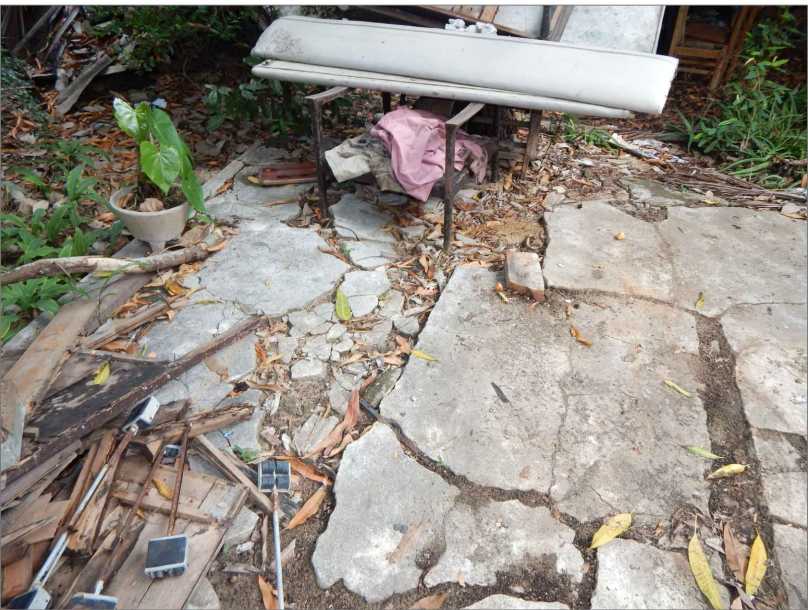
IMAGEN 9: DETALLE DE RECUBRIMIENTO DE PISO CON ROTURA DE PLANTILLA.
