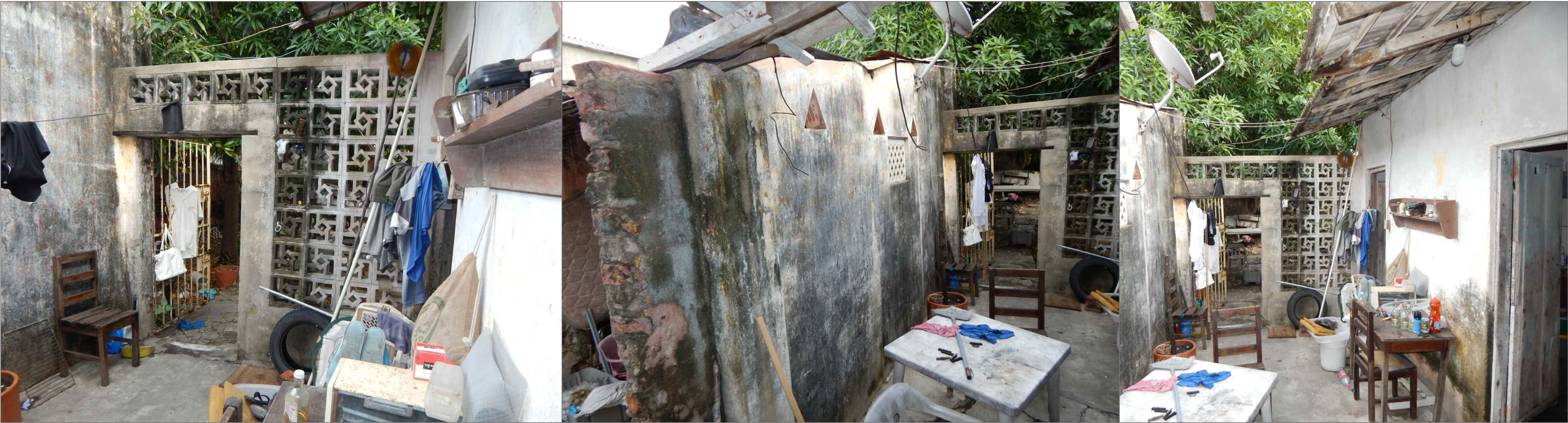
IMÁGENES 3, 4 Y 5: HUMEDADES, HONGOS, MOHOS, LÍQUENES Y DESPRENDIMIENTOS A LO LARGO DEL ESPACIO, QUE SE ENCUENTRA CASI TOTALMENTE DESCUBIERTO.
