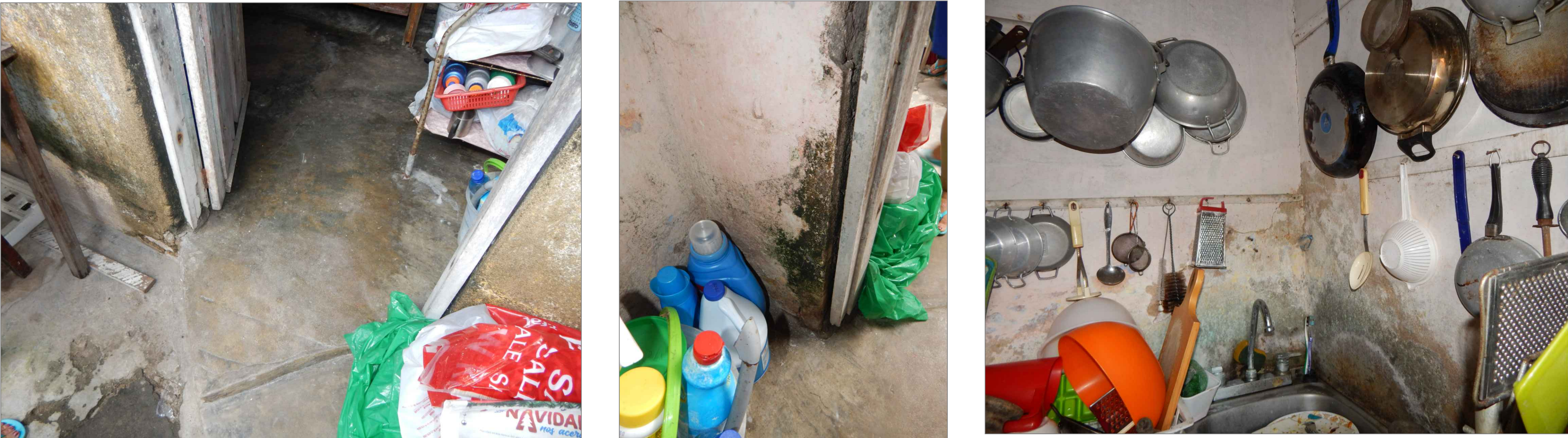
IMÁGENES 4, 5 Y 6: LA COCINA DEL INMUEBLE PRESENTA PISO EN PLANTILLA DE CONCRETO PULIDO CON EROSIÓN GENERALIZADA, EN LOS MUROS SE EVIDENCIA HUMEDAD QUE HA DADO LUGAR A LA PROLIFERACIÓN DE COMUNIDADES BIOLÓGICAS.
