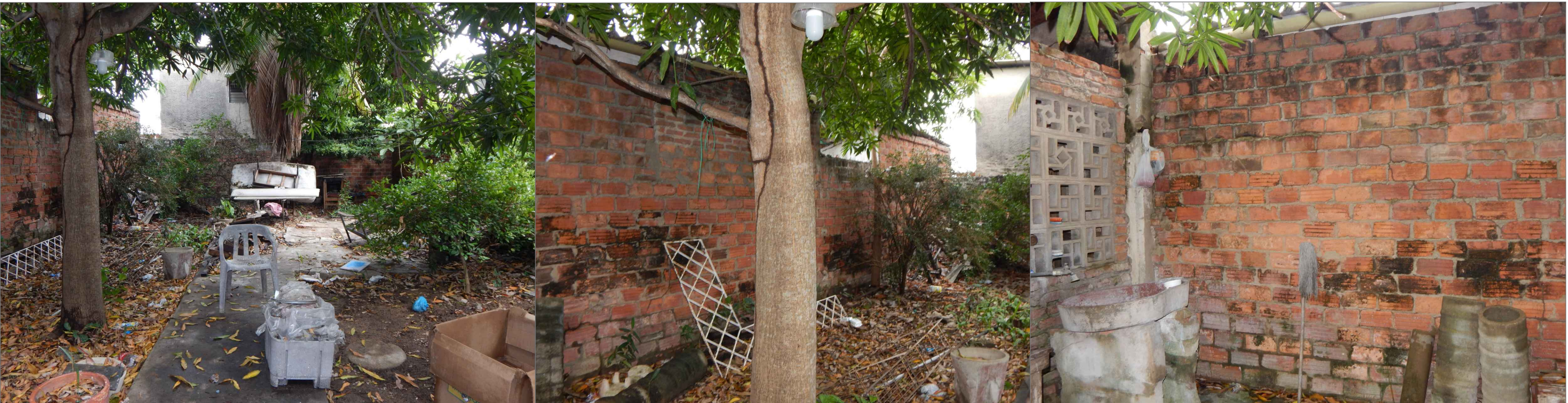
IMÁGENES 3, 4 Y 5: ESTADO GENERAL DEL ESPACIO, CON EVIDENCIA DE MÚLTIPLES LESIONES A NIVEL DE HUMEDADES, EROSIONES, GRIETAS, HONGOS, LÍQUENES, MOHO Y COMEJÉN; PRESENTES EN MUROS Y RECUBRIMIENTO DE PISO. EL PATIO NO PRESENTA CUBIERTA NI SE ASOCIA A ESTE ALGÚN TIPO DE CARPINTERÍA.
