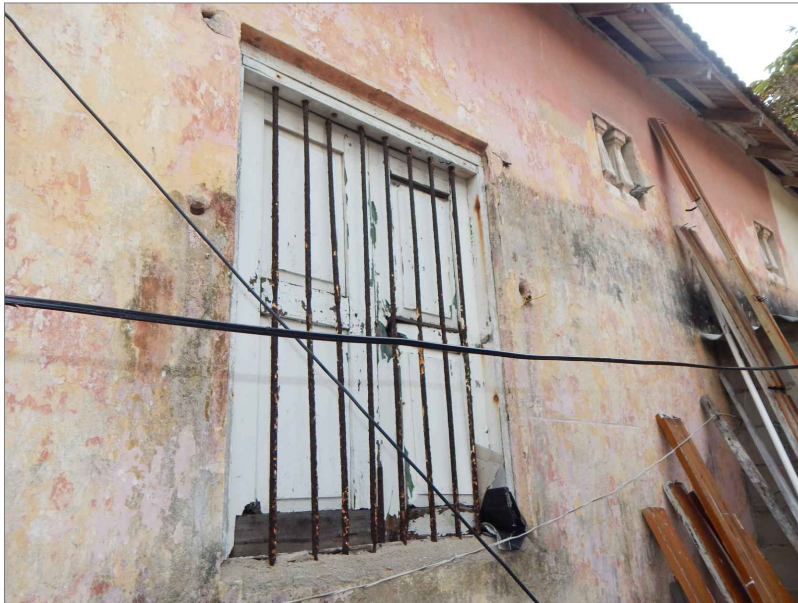
IMAGEN 9: MURO CON AFECTACIONES MÚLTIPLES POR HUMEDADES, VENTANA EN MADERA Y REJA DE LA MISMA CON LESIONES PRODUCTO DE LA HUMEDAD.
