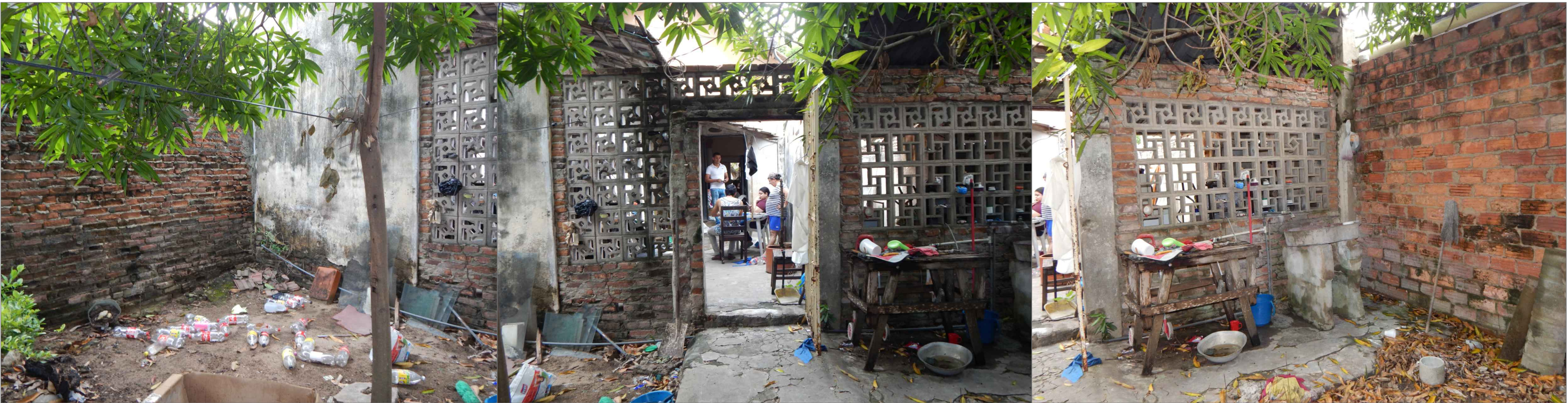
IMÁGENES 6, 7 Y 8: EVIDENCIA DE EROSIÓN ATMOSFÉRICA EN PIEZAS DE LEVANTE DE MUROS. LA EROSIÓN ATMOSFÉRICA SE INTENSIFICA CON LA CLIMATOLOGÍA PROPIA DE LA CIUDAD CON EL AGRAVANTE DE LA AUSENCIA TOTAL DE PAÑETE DE RECUBRIMIENTO. EL NIVEL DE EROSIÓN ES ALTO CON INCLUSO PÉRDIDAS TOTALES DE PIEZAS.
