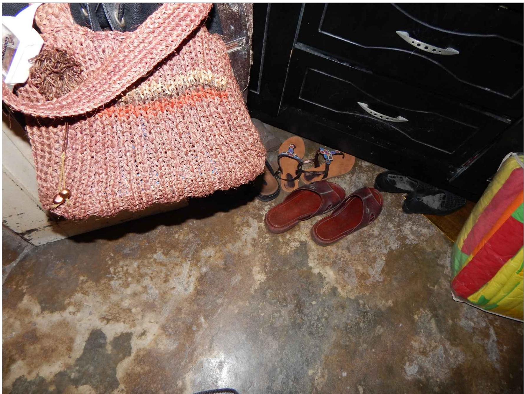
IMAGEN N° 5: PISO CON EROSIÓN GENERALIZADA.
