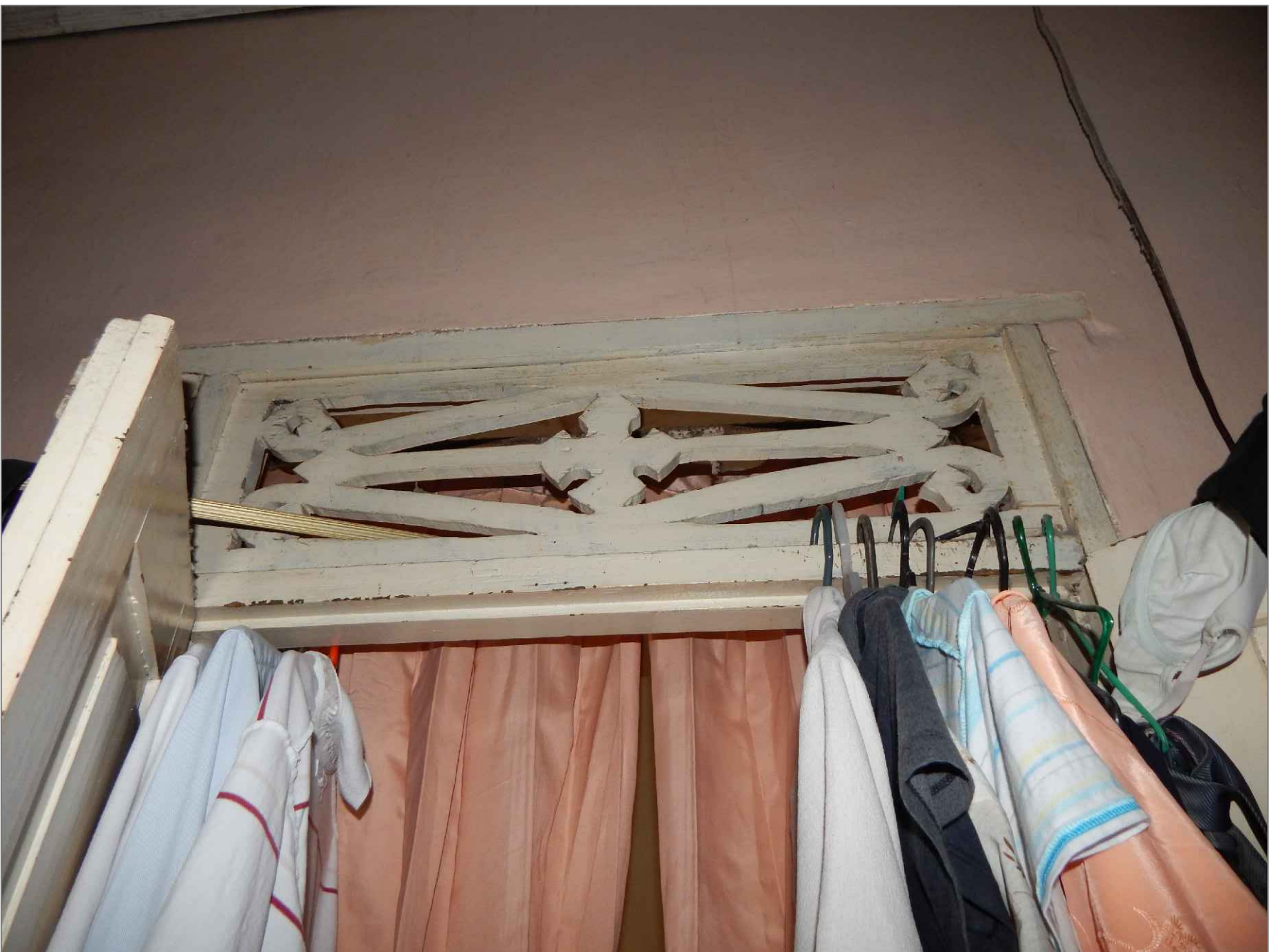
IMAGEN N° 6: CARPINTERIA EN MADERA PARA PUERTAS EN ESTADO DE CONSERVACIÓN ACEPTABLE.
