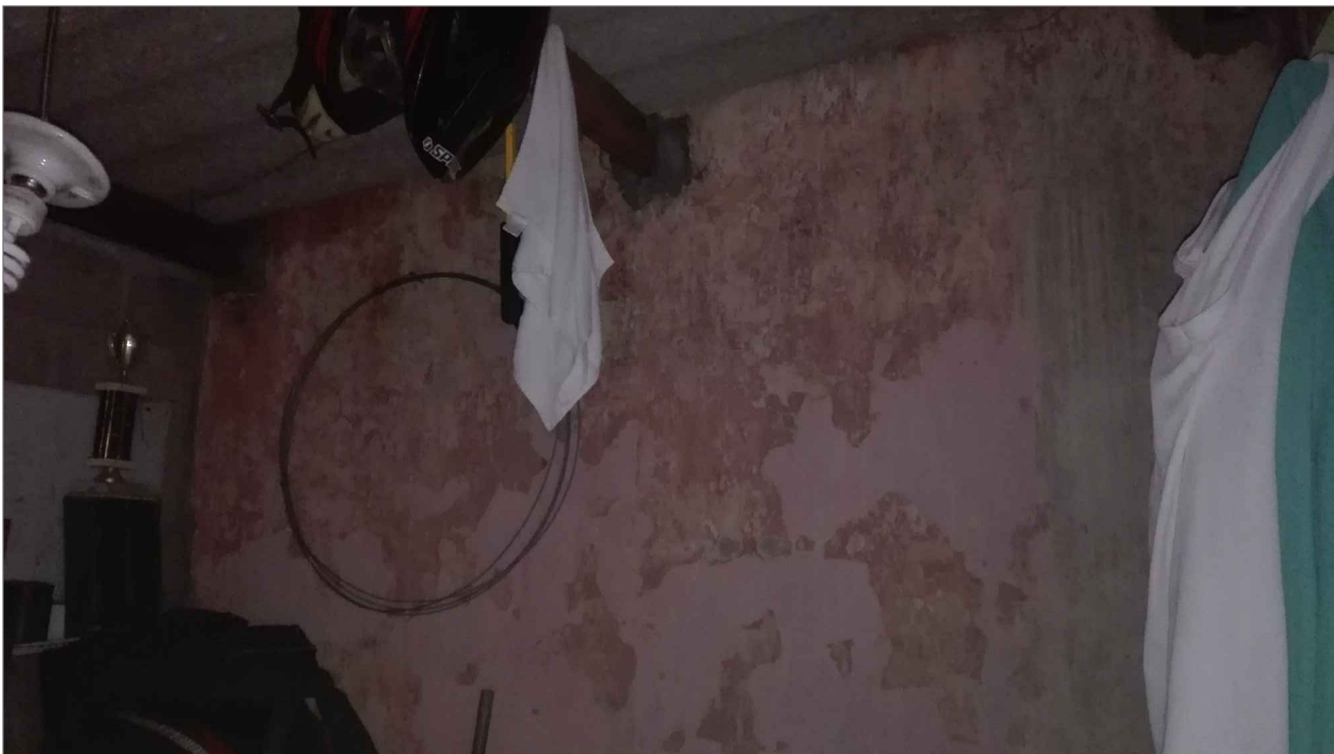
IMAGEN N 5: AFECTACIONES POR HUMEDAD POR FILTRACIÓN EN MUROS.
