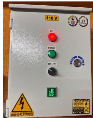
Figura 21. Panel de potencia – fuente propia
