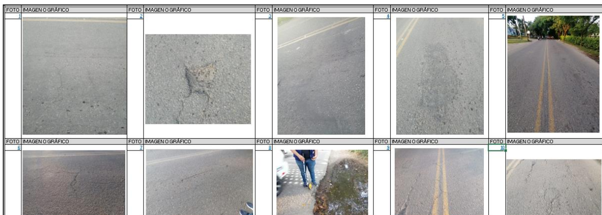
Ilustración 7. Formato de evaluación del pavimento flexible, Fotografías de los daños.
