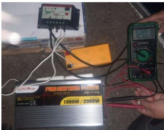
Figura 47. Conexión y medición sistema energización. Fuente: Autores.
