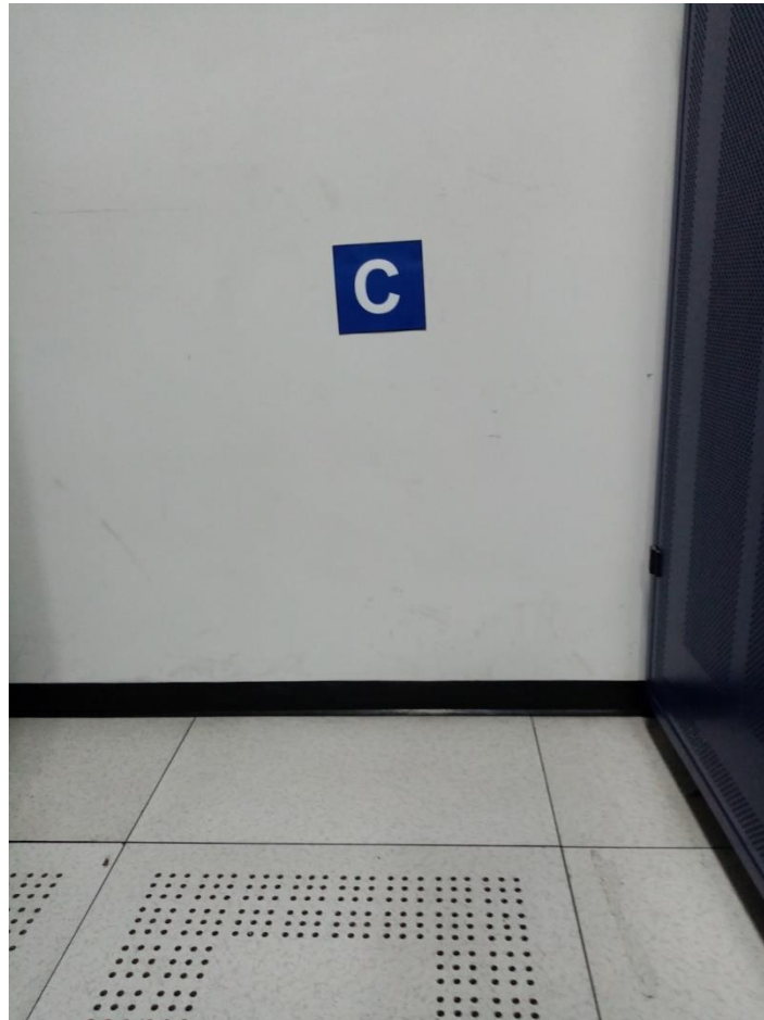
Figura 12. Marcación pasillo frío.
