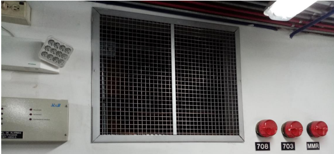
Figura 31. Ducto de ventilación hacia el equipo de confort.
