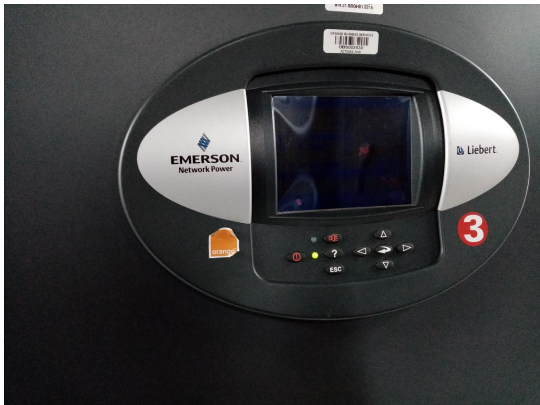
Figura 27. Panel del equipo Liebert.
