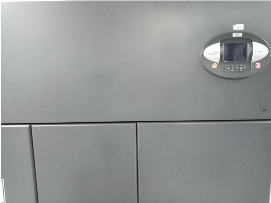
Figura 28. Equipo completo Liebert.
