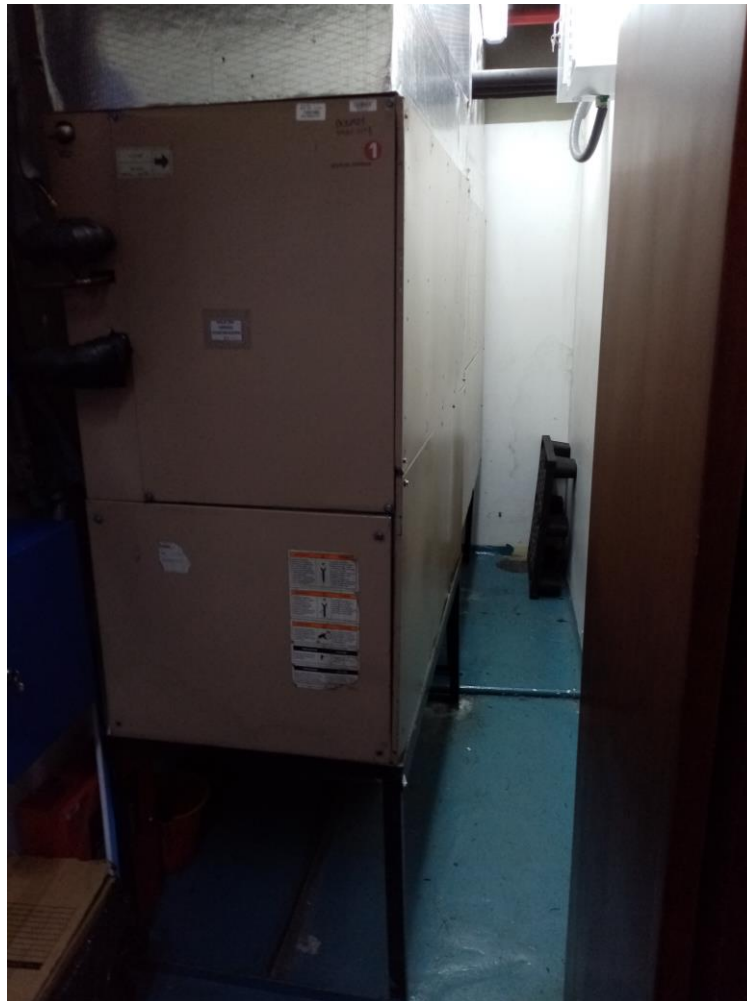
Figura 14. Ubicación de los equipos de confort.
