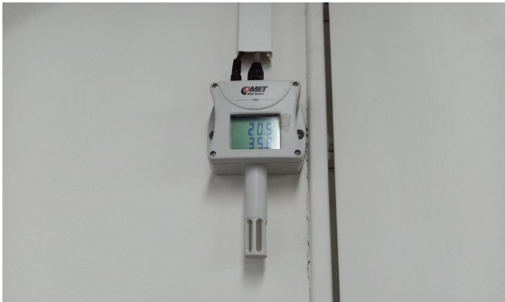
Figura 23. Sensor de temperatura Comet del data center.
