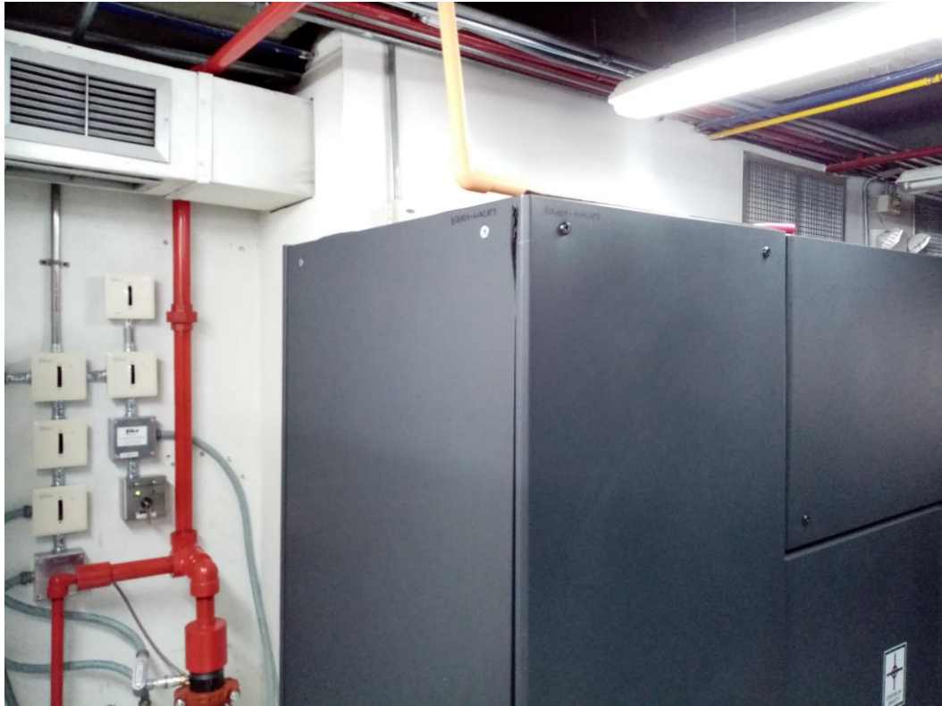
Figura 32. Sistema de ductos de ventilación.
