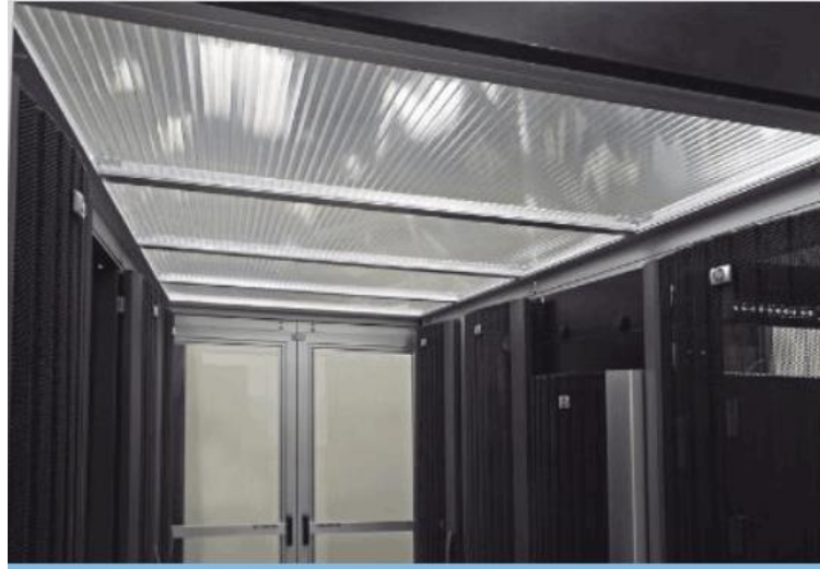
Figura 45. Reflectores para la parte superior del pasillo.
