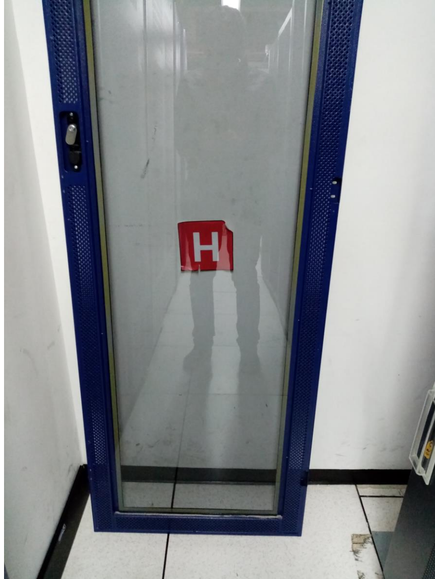
Figura 13. Marcación pasillo caliente.
