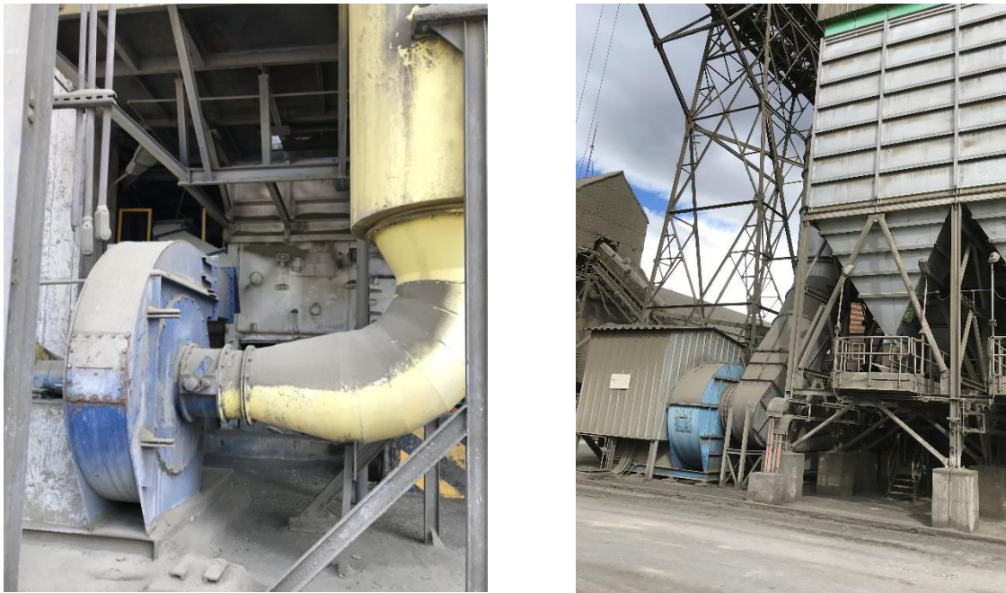
Figura 6. Ventilador con ducto de captación 295 y ventilador 302
