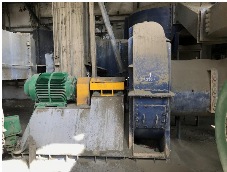
Figura 8. Sistema de transmisión de potencia ventilador
