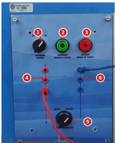
Figura D.3 — SOP-03: tablero de encendido; arranque con la muletilla en RECIRCULACIÓN.
