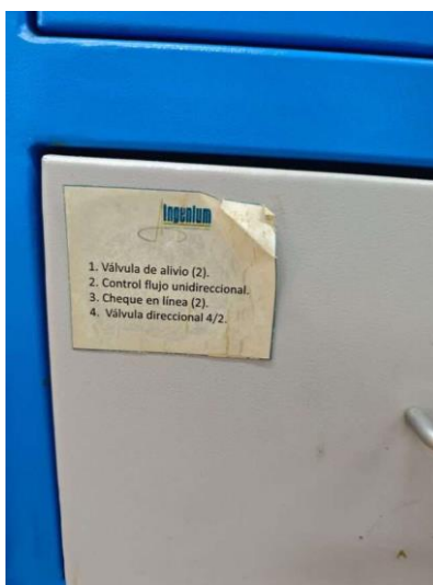
Figura C.2 — Rótulo del fabricante (grupo 2): válvula de alivio (2), control de flujo unidireccional, cheque en línea (2) y válvula direccional 4/2.
