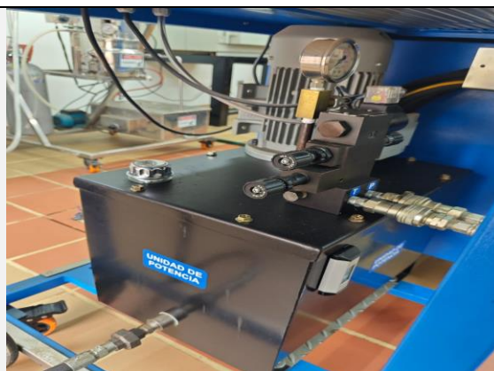
Figura E.2 — Unidad de potencia antes de la corrección de la secuencia de fases.
