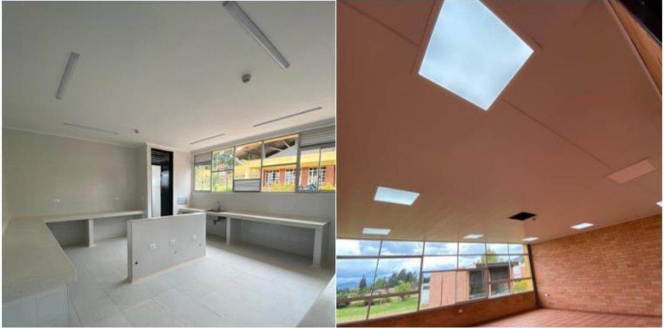
Figura 30. Evidencia ubicación de tomas e iluminarias
