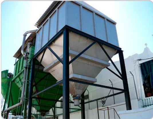
Figura 27. Tolva de almacenamiento de subproducto
